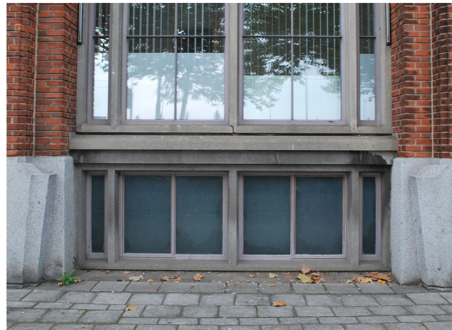
Kozijn type 10: (begane grond, uitgezonderd westgevel) - origineel betonkader; - origineel stalen kozijnen en ramen; - voorzien van enkel glas; - te openen ramen conform oorspronkelijke indeling; - veelal voorzien van origineel hang- en sluitwerk; - deels voorzien van figuurglas, dicht paneel en ventilatierooster.
