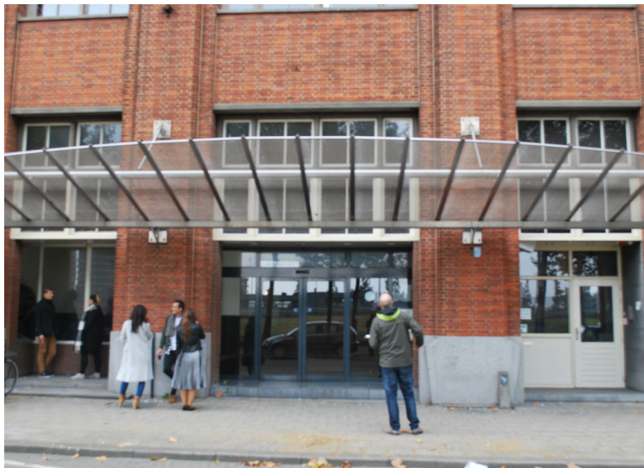
Kozijn type 8-9: (begane grond, entree zuidgevel) - origineel betonkader vervangen; - origineel stalen kozijn en ramen vervangen; - voorzien van enkel glas.
