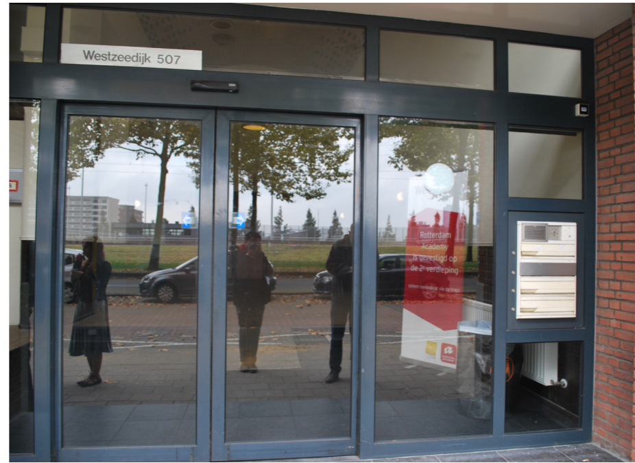
Kozijn type 6: (begane grond, entree zuidgevel) - origineel kozijn vervangen en deels terug geplaatst in de gevel; - aluminium schuifpui; - voorzien van enkel glas.
