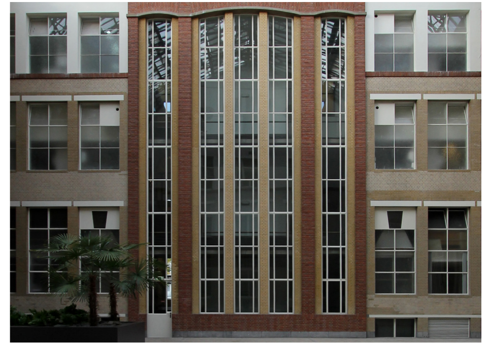
Kozijn type 32-33-34-35: (begane grond/2e verdieping, atrium) - origineel stalen kozijnen en ramen; - voorzien van enkel glas; - veelal voorzien van origineel hang- en sluitwerk.
