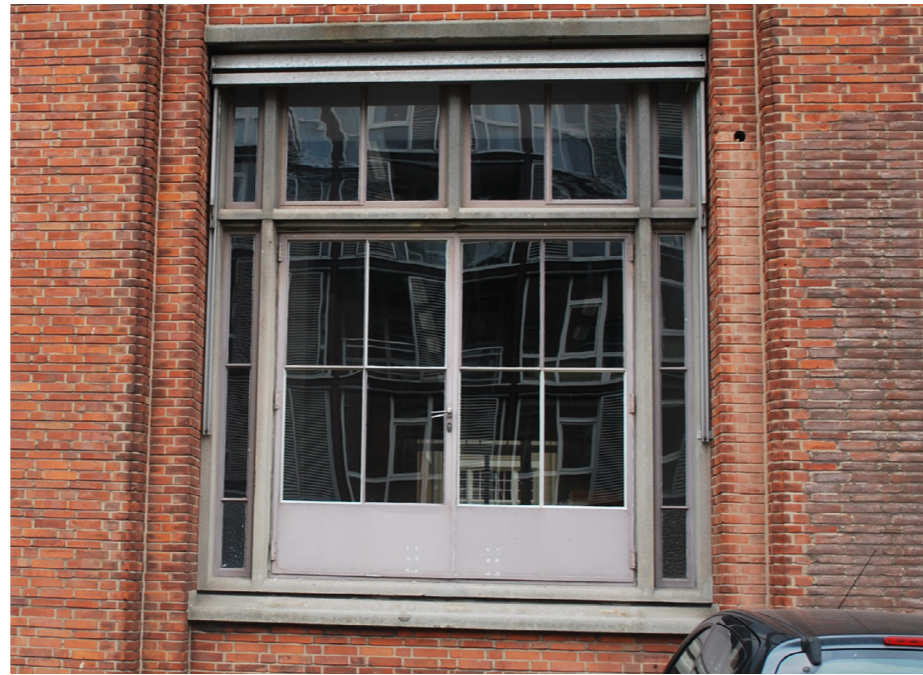
Kozijn type 2c: (1x begane grond, westgevel) - origineel betonkader; - origineel stalen kozijnen en ramen; - voorzien van enkel glas; - te openen ramen conform oorspronkelijke indeling; - veelal voorzien van origineel hang- en sluitwerk; - deels figuurglas in onderste strook; - voorzien van dubbele deur.
