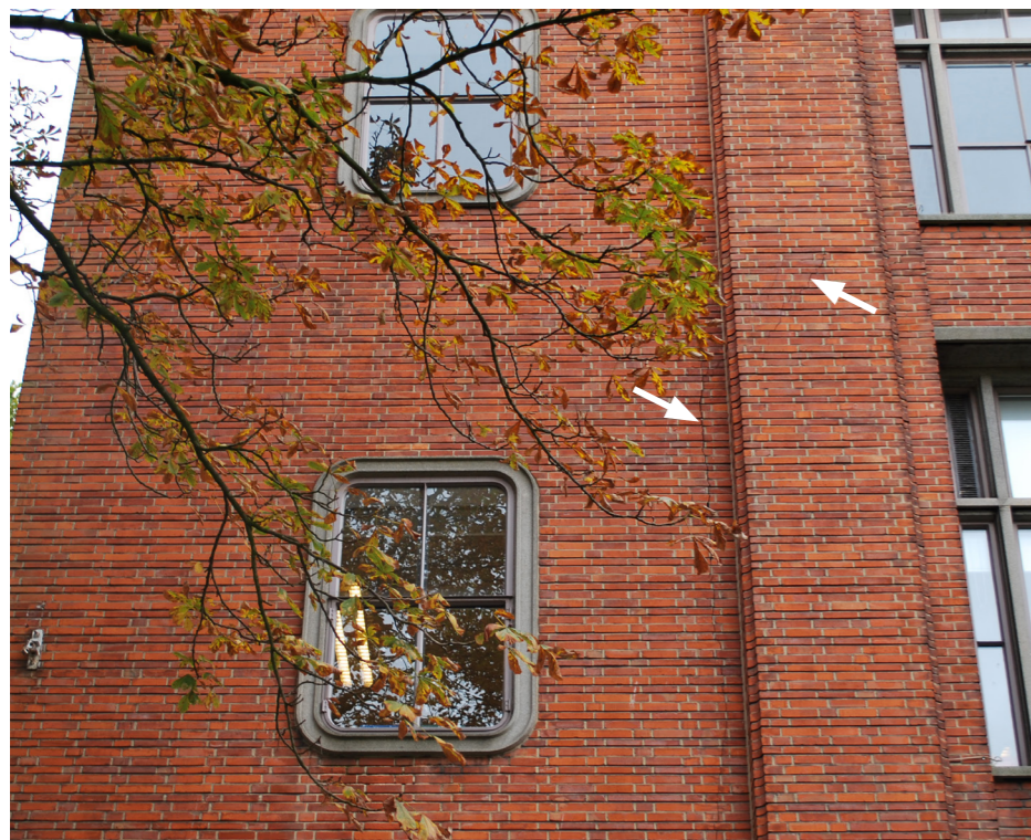
Scheur in noordgevel
