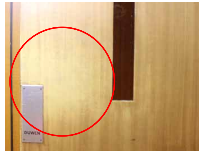
afb 35 - In houtimitatie 2 zijn opnieuw slijtplekken ontstaan. Hier bij de greep van de overschilderde liftdeur op de 2e etage zuid.
