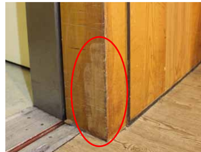
afb 28 - Houtimitatie 2, als retouche aangebracht op een slijtgevoelige plek waar houtimitatie 1 'opgeknapt' is (kozijn 2e etage zuid)
