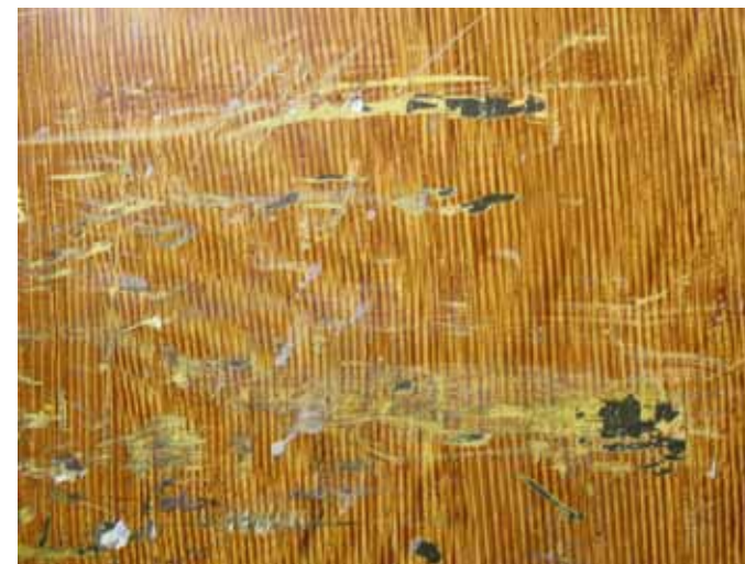
afb 33 - Slijtplekken en lacunes in houtimitatie 1 op schophoogte. De grondlaag, maar ook de technische laag en de groene afwerkingslaag uit het vorig afwerkstadium is te zien bij de lacunes.
