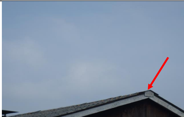
Foto nr. 3, Nokvorsten van loods 2 identiek aan M 3 asbest (gedeeltelijk asbest/gedeeltelijk staal) als asbesthoudend materiaal saneren
