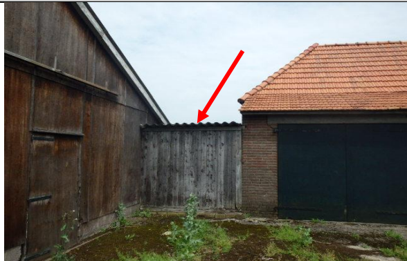
Foto nr. 11, asbesthoudende golfplaten dak aanbouw identiek aan M 3
