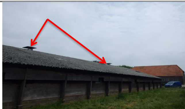
Foto nr. 9, luchtkokers loods 2, asbest identiek aan M 1
