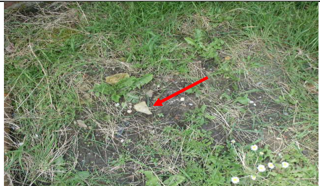
Foto nr. 13 zwerfasbest tussenruimte tussen loods 1 en loods 2 identiek aan M 3
