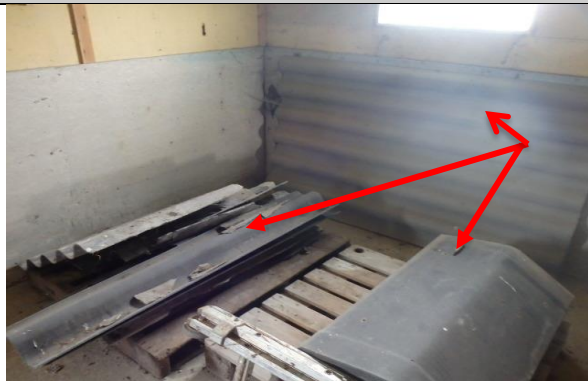
Foto nr. 10, zwerfasbest rechts achter in loods 2, asbest identiek aan M 3
