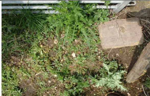
Foto nr. 14 zwerfasbest tussenruimte tussen loods 1 en loods 2
