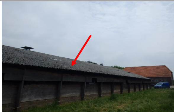
Foto nr. 2, Golfplaten van loods 2 identiek aan M 3 asbest
