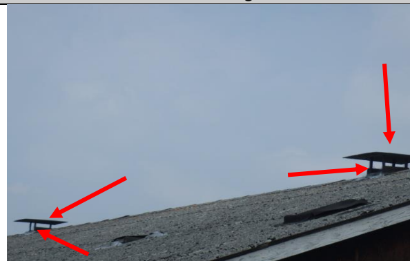
Foto nr. 8, luchtkokers loods 2, asbest identiek aan M 1
