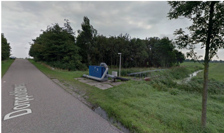
Tijdelijk gemaal (bron: google)
