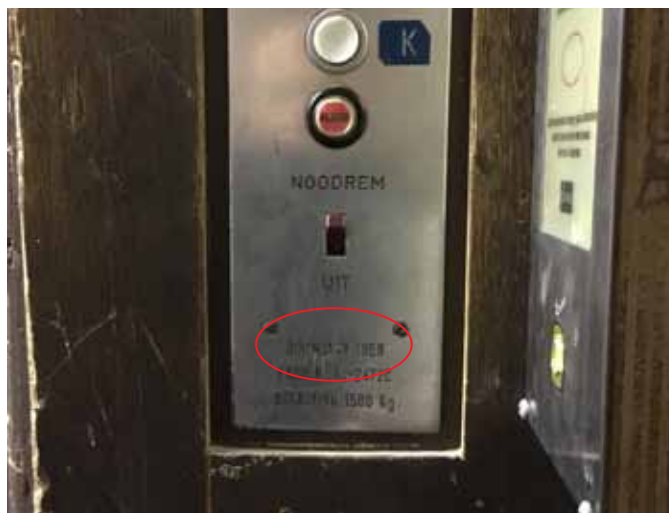
afb 9 - Het bedieningspaneel in de huidige liftkooi van Goederenlift I met bouwjaar 1959
