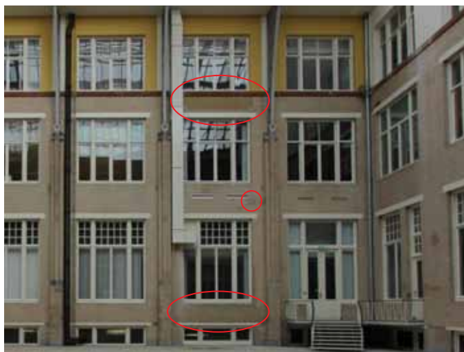
afb 8 - Oostgevel atrium op de plaats van de verdwenen Goederenlift II, met ingeboet metselwerk (MEI: foto's bestaand, p 63)
