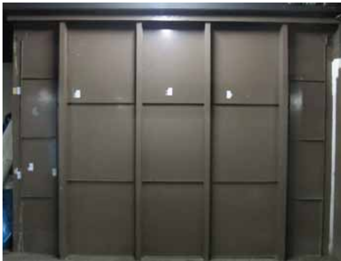
afb 22 - Deurenwand atriumzijde in de kelder met smalle raamstroken naast dichtgezette deuropening. Boven de deuropanging (rails van schuifdeuren), onder een slijtdorpel over de gehele breedte
