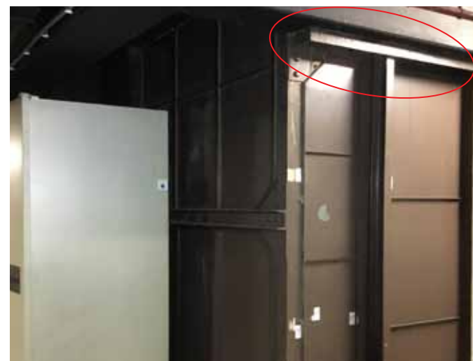
afb 21 - Linkerzijwand liftschacht op kelderniveau, huidige situatie, met rechts de dichtgezetten deuren waarboven de ophanging. De zes glasruiten zijn vervangen door in het raamprofiel gelaste plaatjes
