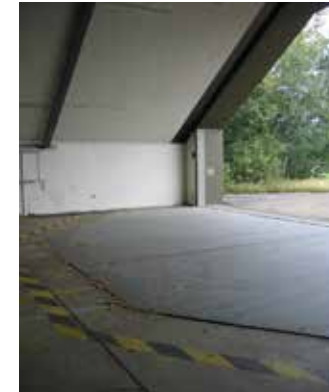
Hydraulische deur in vliegtuig-shelters scharniert vanuit de vloer.
