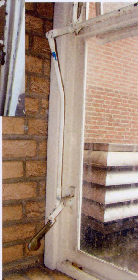
Raammechanisme in gebouw B
