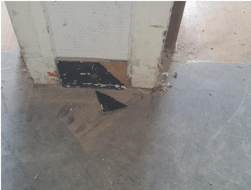
Fb01: Diverse plinten toegepast in het pand zijn niet asbestverdacht.
