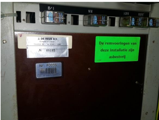
Fb04: Remvoeringen van de liftinstallatie zijn asbestvrij.
