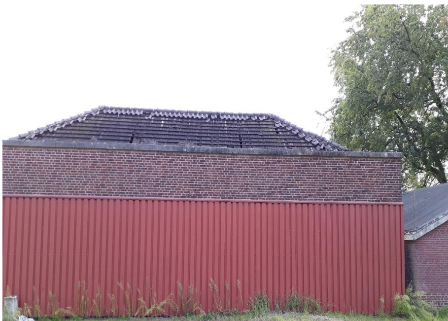
Foto 2: Beschadigd dak met openingen aan het Klasse paviljoen vrouwen.
