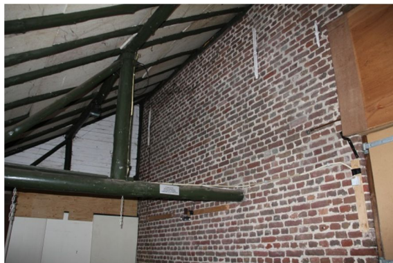
Afb. 28 Het linker gedeelte van de achtergevel met uiterst rechts de poortopening waarin een nieuw kozijn is geplaatst en dat deels (boogveld) is afgetimmerd).
