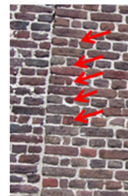
Afb. 16 Grens tussen schuur en woning. De rode pijlen geven de klezoren aan. Deze ontbreken bij de woning, waardoor de gevel 'rommelig' wordt beeindigd.
