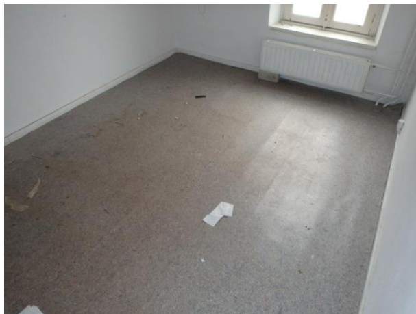
impressie van ruimte 0.05 (het asbesthoudend vloerzeil ligt onder het zichtbare asbestvrije zeil)
