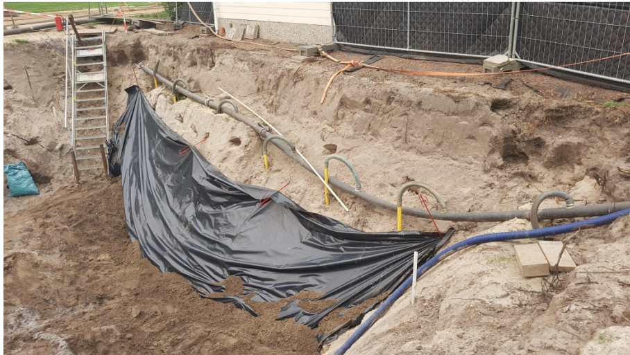
Restverontreiniging afgeschermd door folie (wand W3 van 3,0 tot 4,0 m -mv)
