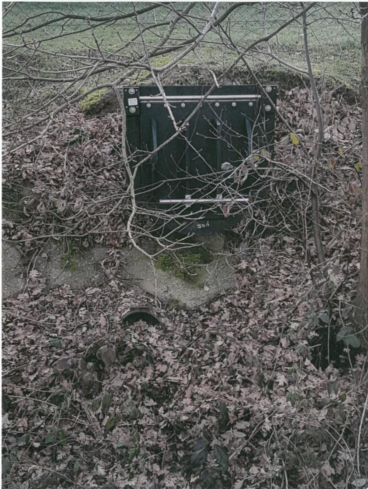
Bijlage 1: foto lozingswerk met terugslagklep
