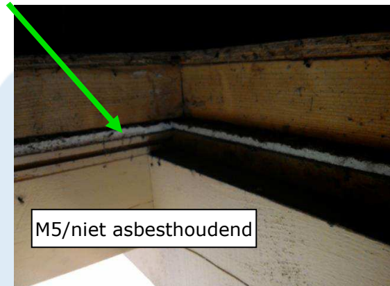
Foto 20 | Brandwerende beplating tussen plafond en vloer
