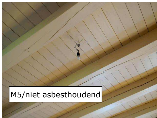
Foto 19 | Brandwerende beplating tussen plafond en vloer
