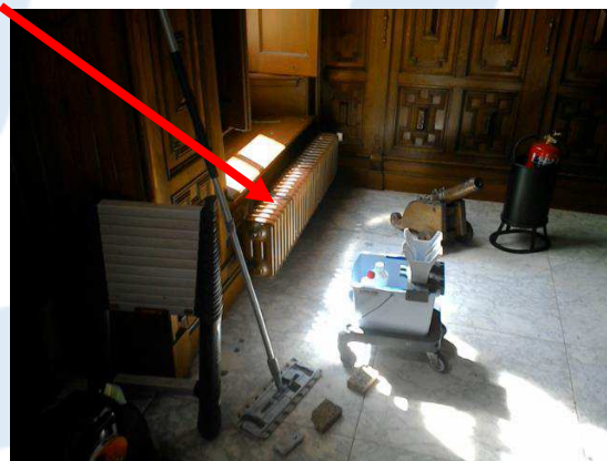
Foto 23 | Pakkingen in lamellen radiatoren
