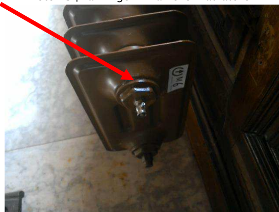
Foto 25 | Pakkingen in lamellen radiatoren
