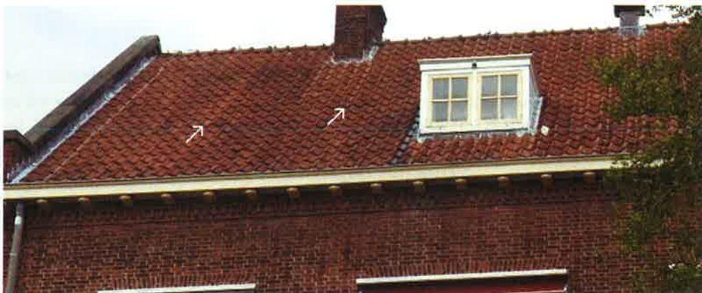
Foto 1: Openingen die vleermuizen toegang verschaffen tot het pannendak.
