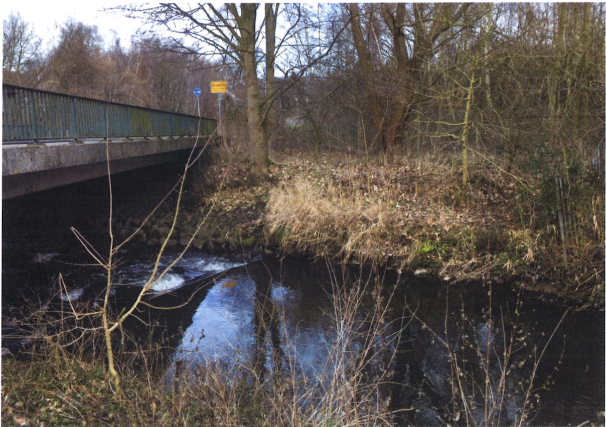
Figuur 2: huidige situatie bovenstrooms brug – aanwezige bodemval
