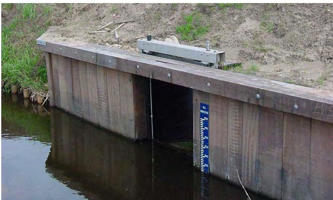
Figuur 8: Kunstwerk K3, uitlaat seizoensberging. Dit is een halfronde put met een overstortschuif die elektrisch bediend kan worden d.m.v. Green box. Op de achterkant van de put wordt de duiker bevestigd.
