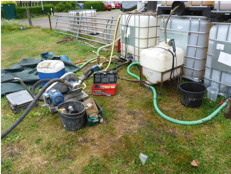
foto 8: P1050982.JPG: Pomp voor aanvoer aangemaakte injectievloeistof naar buffervat.
