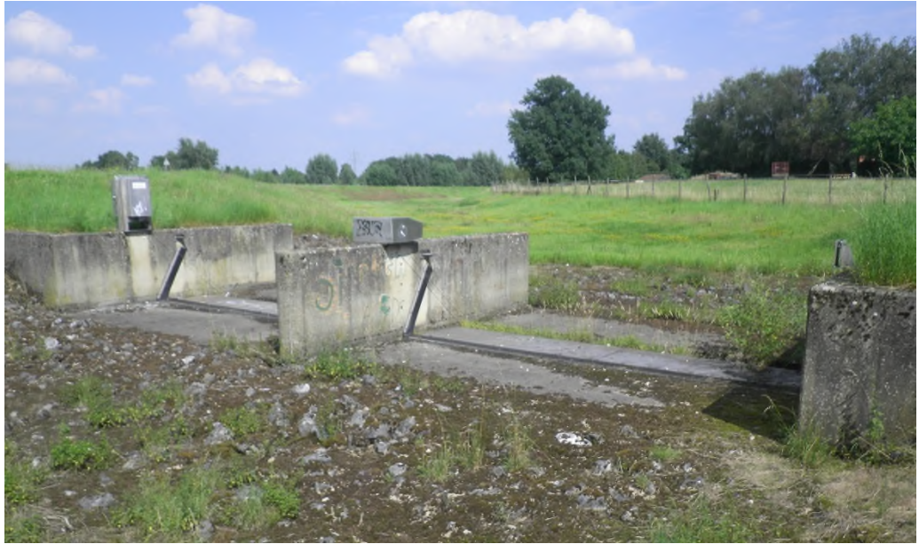
Figuur 4-7: Dijkvak 3; Kunstwerk aan de buitenzijde van de dijk, rand Neerbeek. Regelwerk van de bypass Neerbeek.
