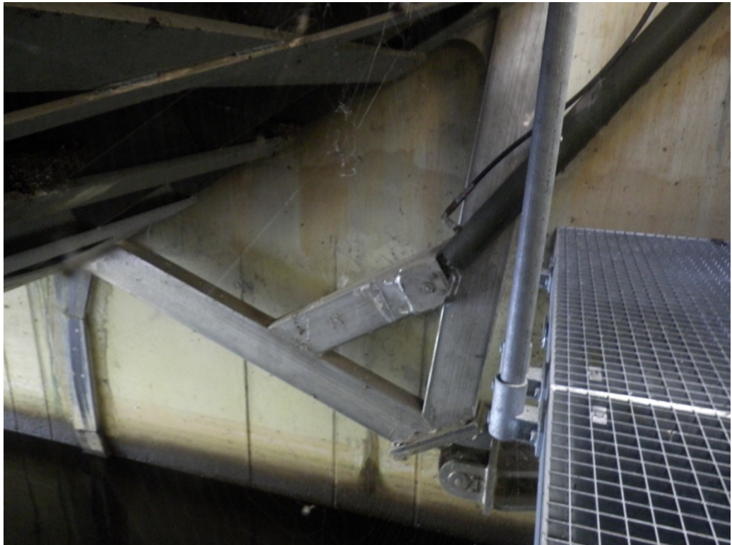
Figuur 4-5: Dijkvak 2, Ophangpunt van de segmentschuiven in de Hammermolenstuw.
