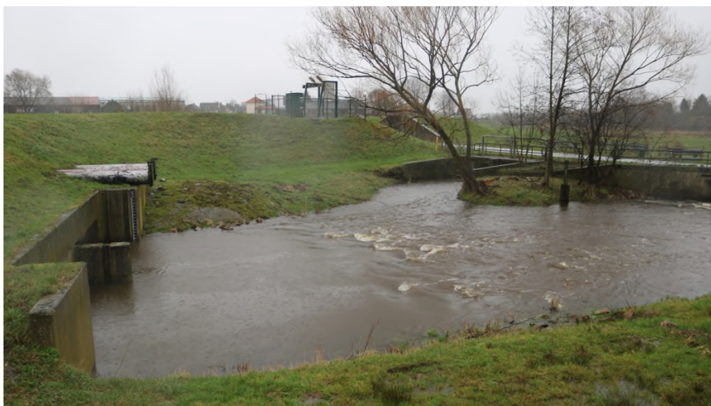
Figuur 4-14: Dijkvak 7, met links de Winkelmolenstuw met persleidingen met terugslagklep. Op de dijk is het pompstation van de rioolpersleiding zichtbaar, met ernaast de coupure van de Molenstraat. Aan de rechterzijde de brug over de Neerbeek.
