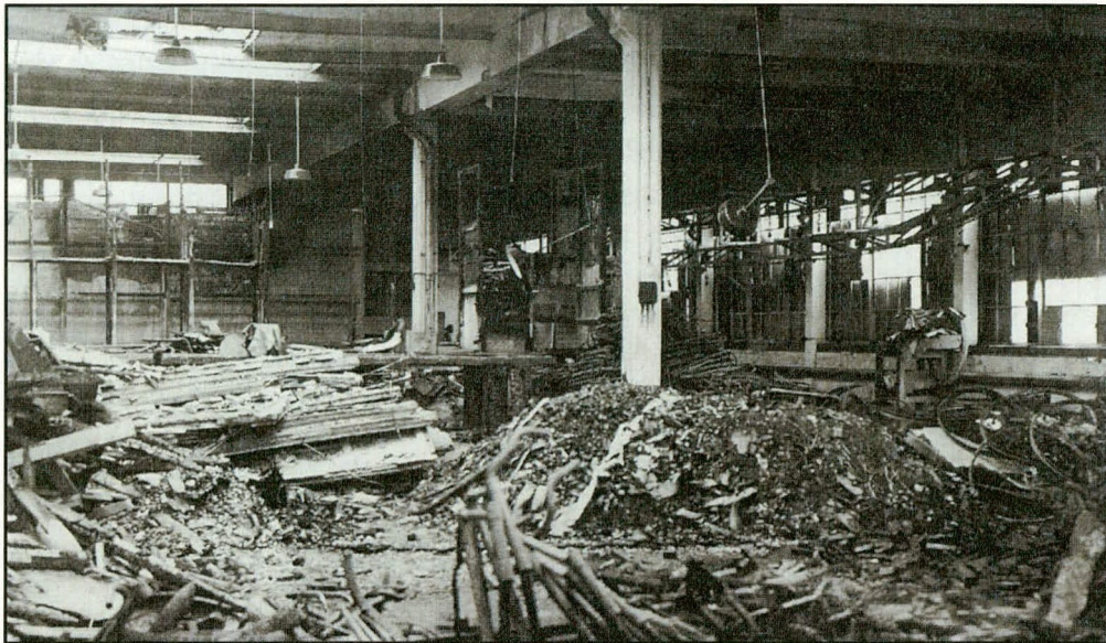
Figuur 4 De uitgebrande montagehal van de rijwielfabriek Empo aan de Insulindelaan in Vorden. Bron: R. Ellenkamp, Vorden tijdens de bezetting (Vorden 1997) 135.
