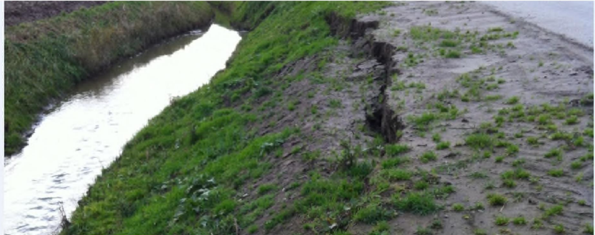
Figuur 2: Foto van een afgeschoven talud NW
