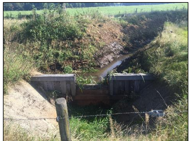
Afbeelding 2.8: schotbalkstuw in waterloop 20-0-4-3
