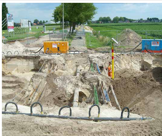
Kabels en leidingen
