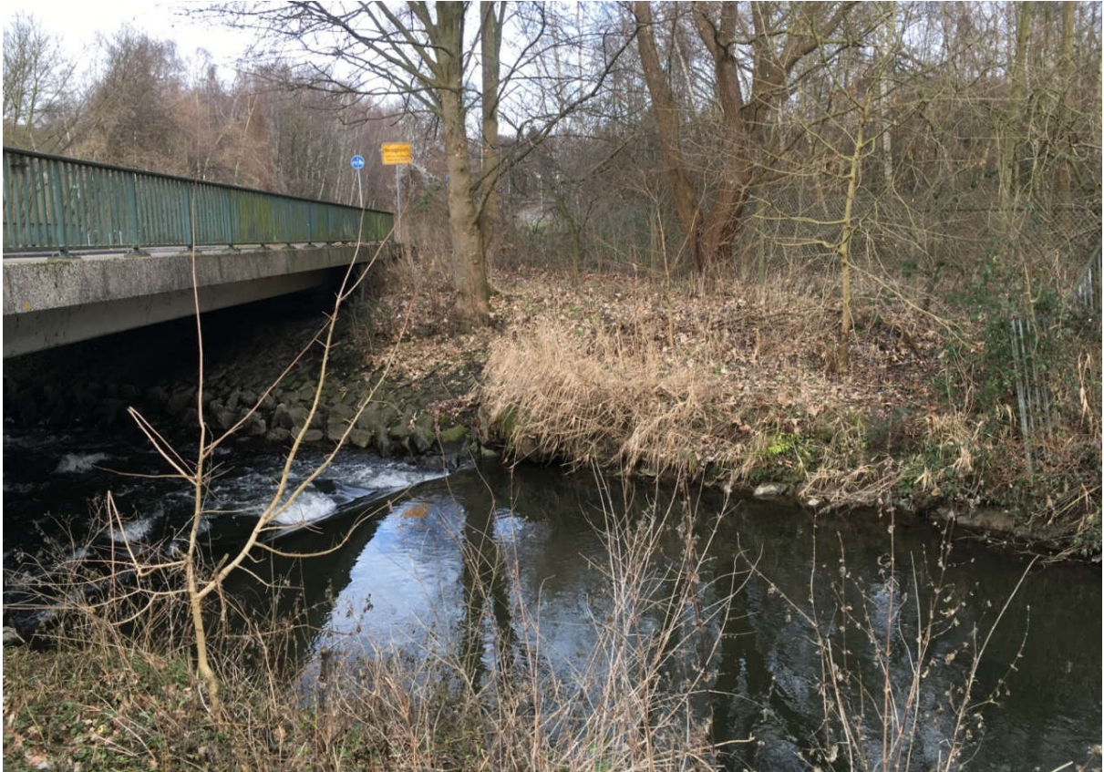
Figuur 2: huidige situatie bovenstrooms brug – aanwezige bodemval
