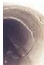
scheuren in de rioolbuis waardoor deze mogelijk kan instorten
