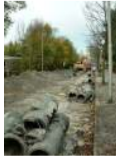
slechte riolen worden tijdig vervangen
