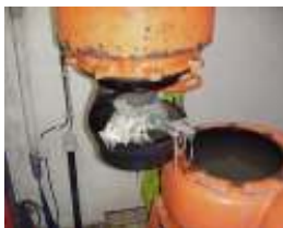
gemalen verkeren in een slechte technische staat
