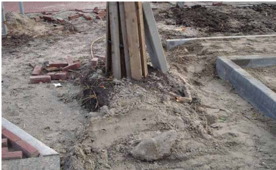
Bij deze herinrichting is er wél bovengronds rekening gehouden met de boom; er zijn immers beschermplanken om de stam gezet. Over de impact op het wortelgestel is duidelijk niet nagedacht. Het moge duidelijk zijn dat deze boom dit niet overleeft.
