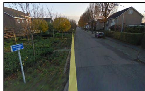
Figuur 19 Wegdek op Jan Joostenstraat
