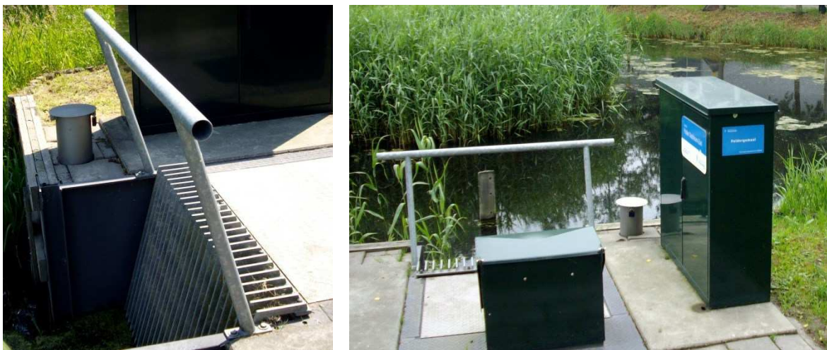
Figuur 8: voorbeeld gemaal met schakelkast
