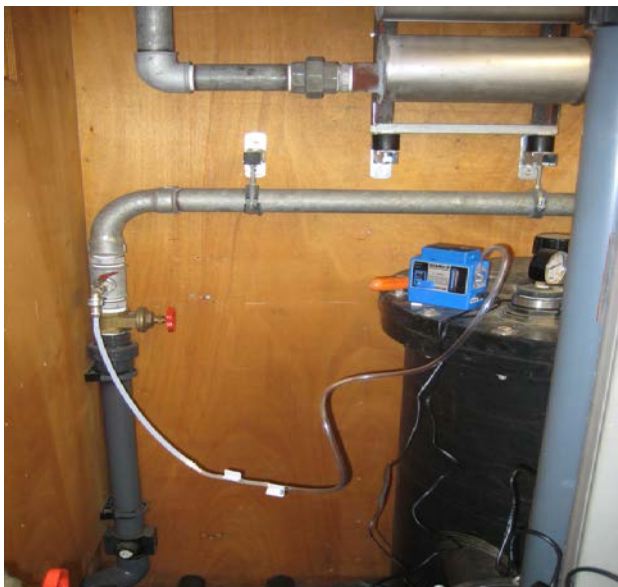
Foto : Meetpunt BLE unit
