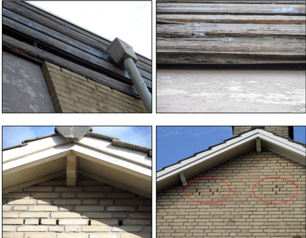
Boven: ruimte tussen en onder de gevelbetimmering. Onder: Open stootvoegen aan de kopse kant van de woningen aan de Dorpsstraat.
