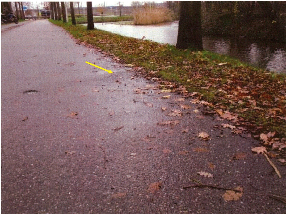
Foto 4: Scheurvorming in het asfalt van het fietspad, aangegeven met geel gekleurde pijl. Ter hoogte van de zomereik met boomnummer 7.
