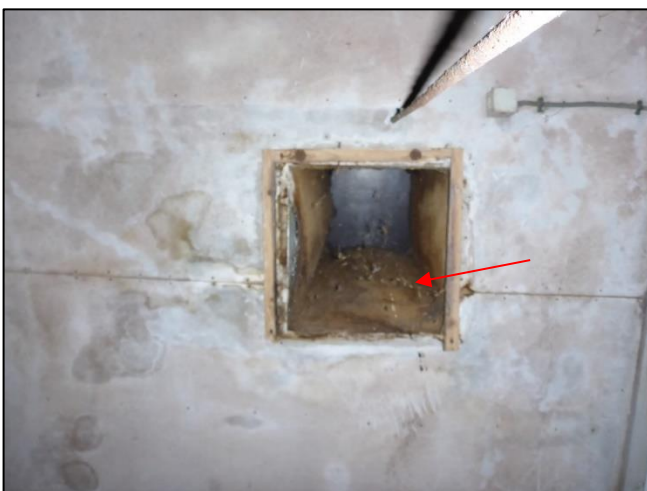
Foto 5: Schuur 1: Ventilatiekoker (M01AZ)
