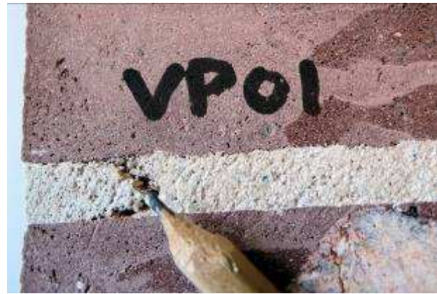
Begin van vorstschade in de legmortel achter de voeg; kalkuitbloei op buitenzijde voegmortel
