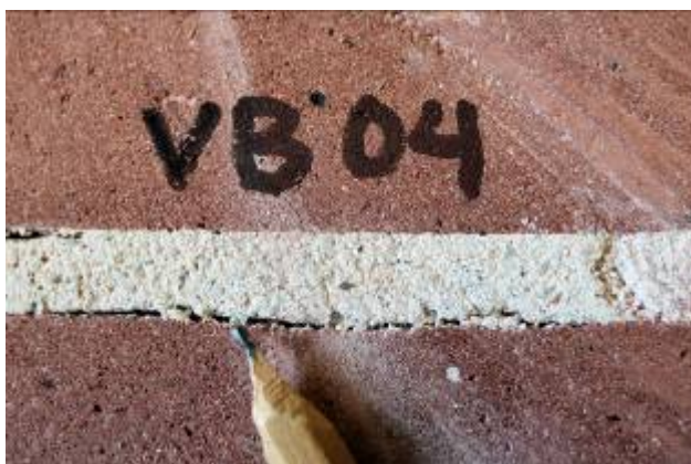
Interface schade legmortel
