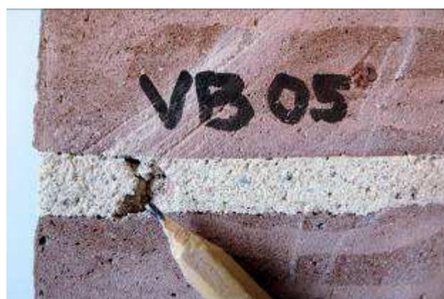
Lichte vorstschade in legmortel achter voeg door slechte opvulling
