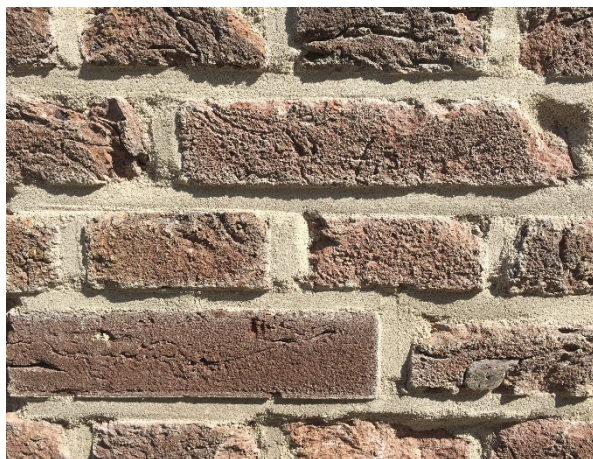
Figuur 5.2: Proefvak door RDrie opgezet tijdens de vakbekwaamheidsproef. Er zijn geen sporen van vorstschade zichtbaar.
