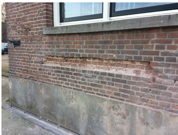
Figuur 3.5: Geïmpregneerde bakstenen zijn uit de gevel van de Pelmolen ontnomen.
