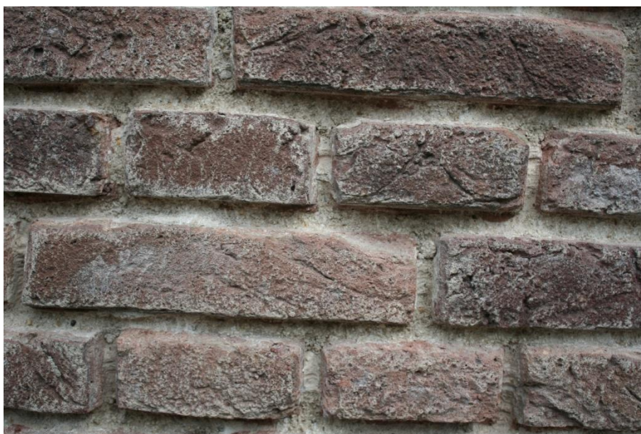
Figuur 22: Uitgehakt proefvak bedrijf 3. Het bedrijf geeft aan klaar te zijn en niet dieper te gaan uithakken. De uitgehakte voegen zijn vol met stof en kruimels van de oude specie en het uithakken.
