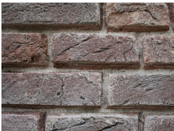
Figuur 18: Close-up van het uitgehakte proefvak. Geen kruimels van uitgehakte mortel aanwezig!
