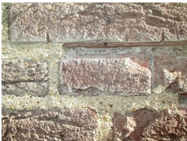
Figuur 6.31: Beschadigd metsel- en voegwerk.
