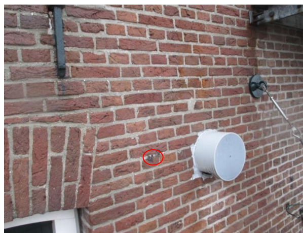
Figuur 6.100: Corroderende oude bevestigingsmiddelen.
