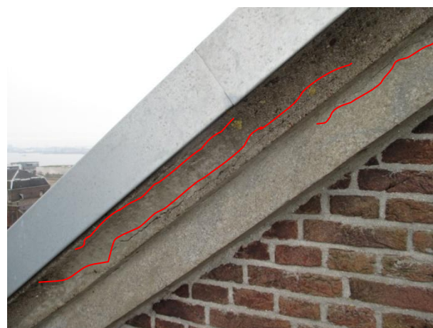
Figuur 6.40: Gescheurd element met oude reparatie a.g.v. corroderende wapening.
