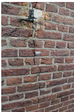
Figuur 20: Scheur door corrosie van de ijzeren gevelelementen.
