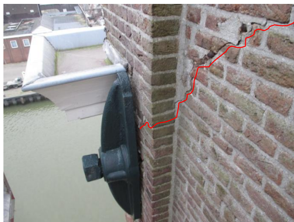
Figuur 6.42: Scheur a.g.v. corroderende elementen.
