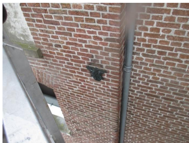
Figuur 6.10: Gebroken muuranker.
