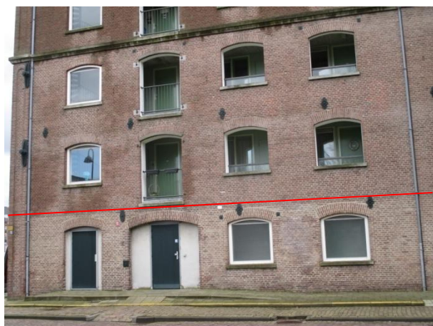
Figuur 6.23: Beschadigd metsel- en voegwerk.
