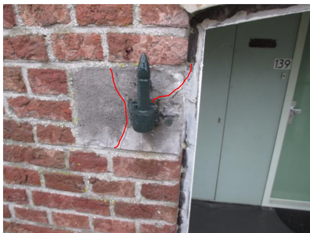
Figuur 6.7: Gescheurd duimblok a.g.v. een corroderende duim.
