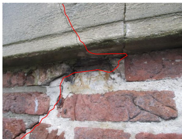
Figuur 6.104: Scheur a.g.v. corroderende elementen in het metselwerk.
