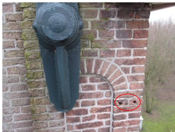
Figuur 6.54: Corroderende oude bevestigingsmiddelen.
