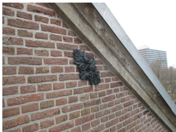
Figuur 6.50: Oude reparatie in element a.g.v. corroderende wapening.
