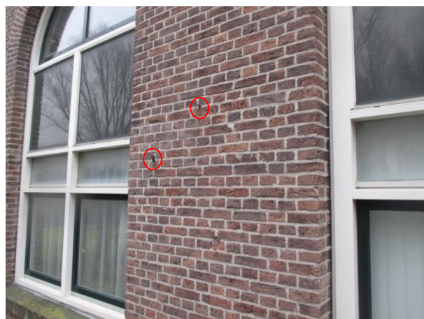
Figuur 6.22: Corroderende oude bevestigingsmiddelen.
