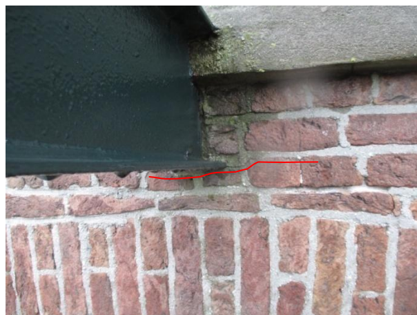
Figuur 6.8: Scheur a.g.v. een corroderende hijsbalk.
