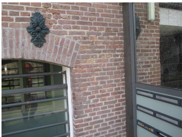
Figuur 6.33: Beschadigd metsel- en voegwerk.
