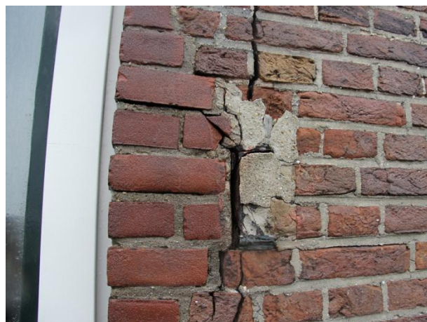
Figuur 21: Scheur door corrosie met risico uitvallen metselwerk.
