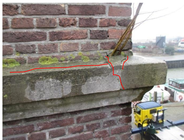
Figuur 6.18: Gescheurd element a.g.v. corroderende wapening met begroeiing.
