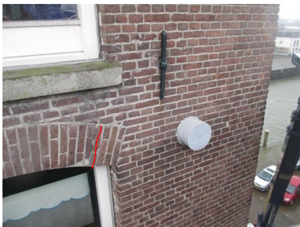
Figuur 6.13: Gescheurde rollaag a.g.v. dilatatie/ thermische krimp.
