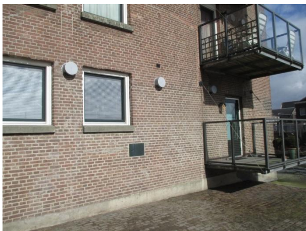
Figuur 6.125: Beschadigd metsel- en voegwerk.
