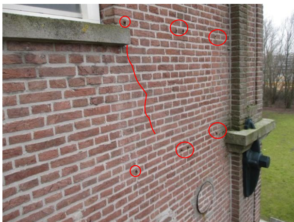
Figuur 6.71: Een scheur a.g.v. dilatatie/thermische krimp en corroderende oude bevestigingsmiddelen
