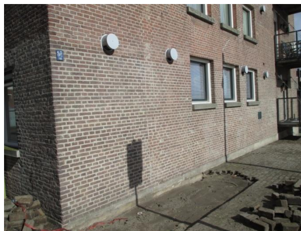
Figuur 6.126: Beschadigd metsel- en voegwerk.
