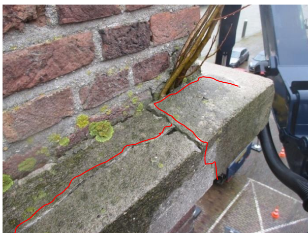
Figuur 6.17: Gescheurd element a.g.v. corroderende wapening met begroeiing.
