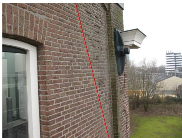
Figuur 6.52: Beschadigd voegwerk.
