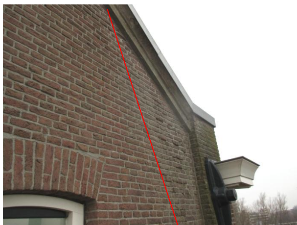
Figuur 6.51: Beschadigd voegwerk.
