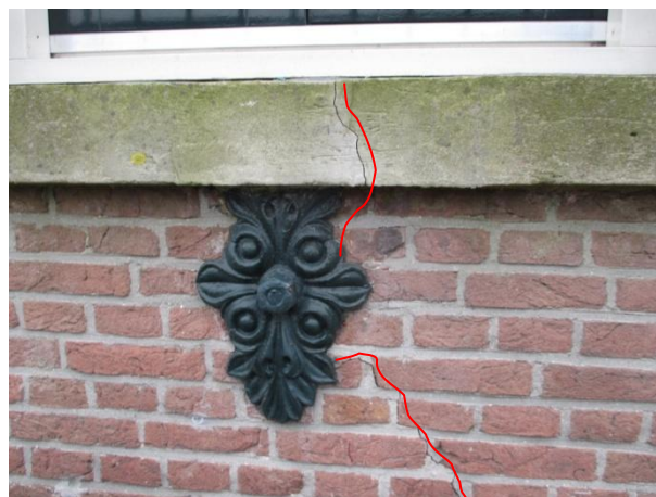
Figuur 6.72: Scheur door ontbreken van latei bij onderliggend nieuw kozijn
