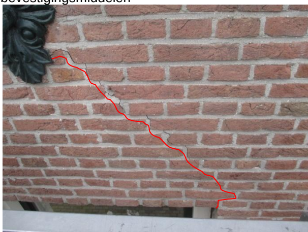
Figuur 6.73: Scheur door ontbreken van latei bij onderliggend nieuw kozijn
