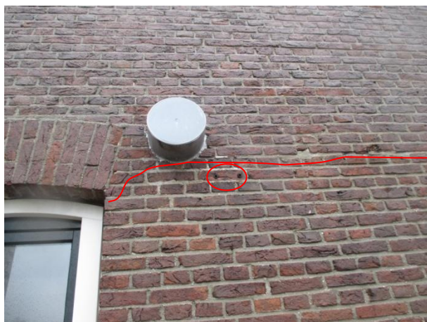
Figuur 6.107: Scheur a.g.v. corroderende elementen in het metselwerk en corroderende oude bevestigingsmiddelen.
