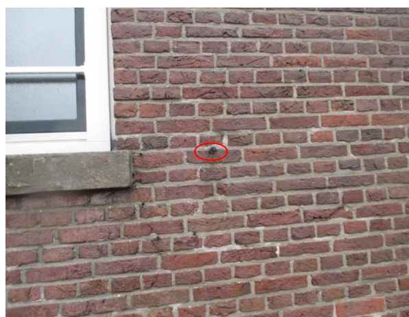
Figuur 6.110: Corroderende oude bevestigingsmiddelen.
