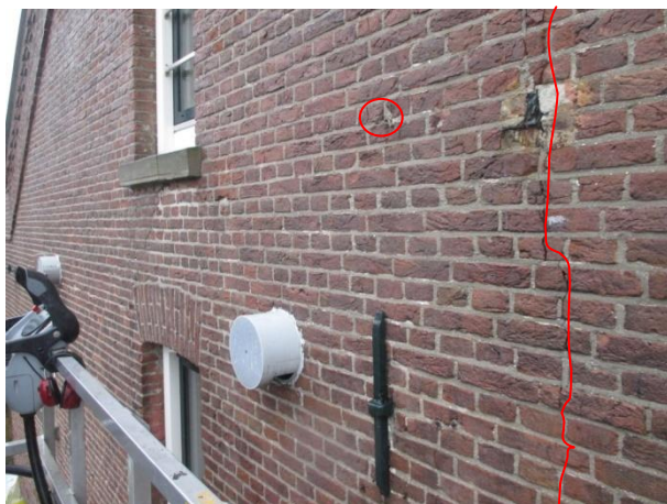
Figuur 6.95: Scheur a.g.v. corroderende elementen in het metselwerk.
