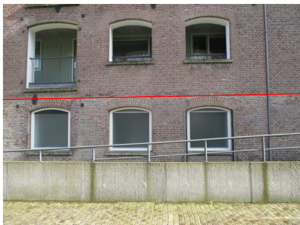
Figuur 6.25: Beschadigd metsel- en voegwerk.
