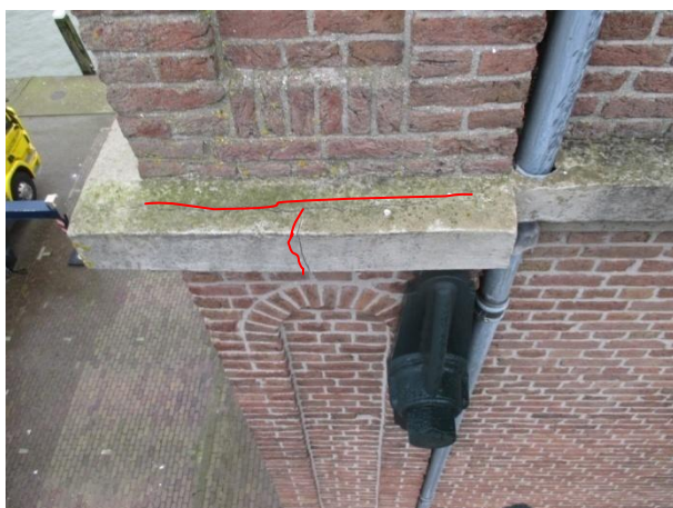
Figuur 6.3: Gescheurd element a.g.v. corroderende wapening.
