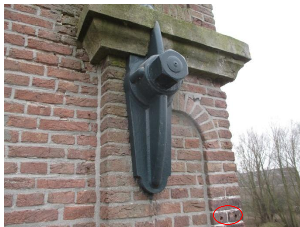
Figuur 6.78: Corroderende oude bevestigingsmiddelen.
