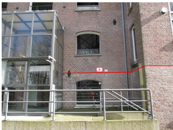
Figuur 6.27: Beschadigd metsel- en voegwerk.
