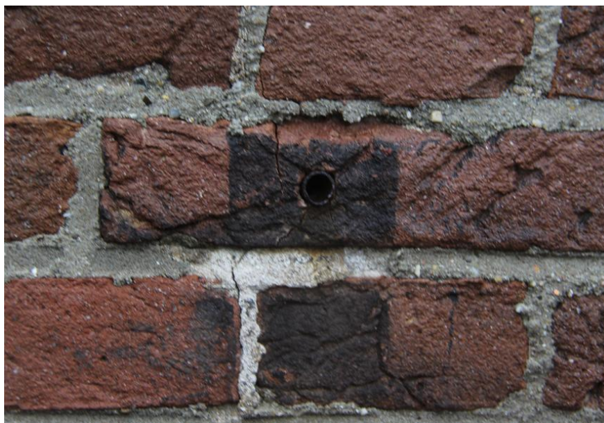
Figuur 14: 1 ste generatie voegwerk achter ankerplaten van de gevelsteiger restauratiebeurt 1988/89).
