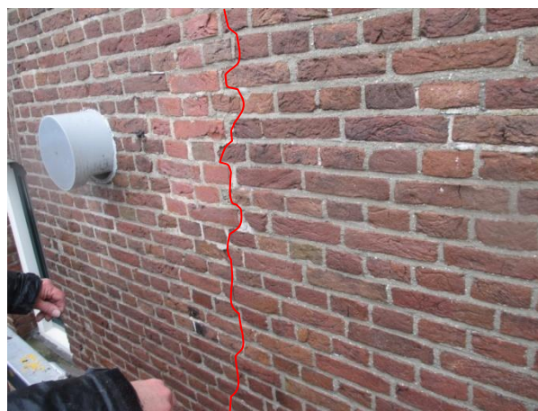
Figuur 6.98: Herstelde en opnieuw gescheurd metselwerk a.g.v. corroderende elementen.
