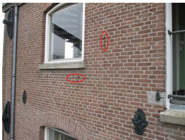
Figuur 6.6: Corroderende oude bevestigingsmiddelen.
