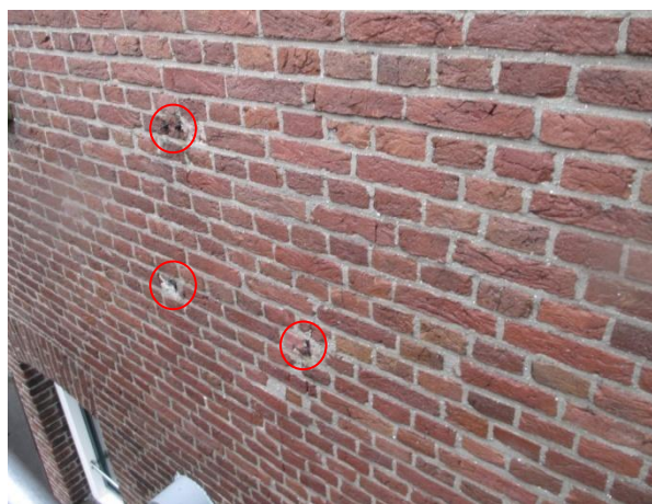
Figuur 6.118: Corroderende oude bevestigingsmiddelen.
