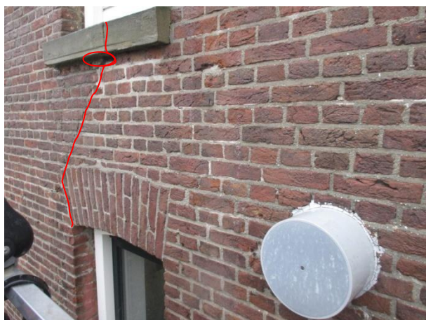
Figuur 6.103: Scheur a.g.v. corroderende elementen in het metselwerk en dilatatie/thermische krimp.
