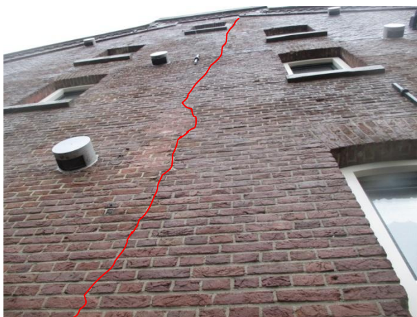
Figuur 6.117: Scheur a.g.v. corroderende elementen in het metselwerk.
