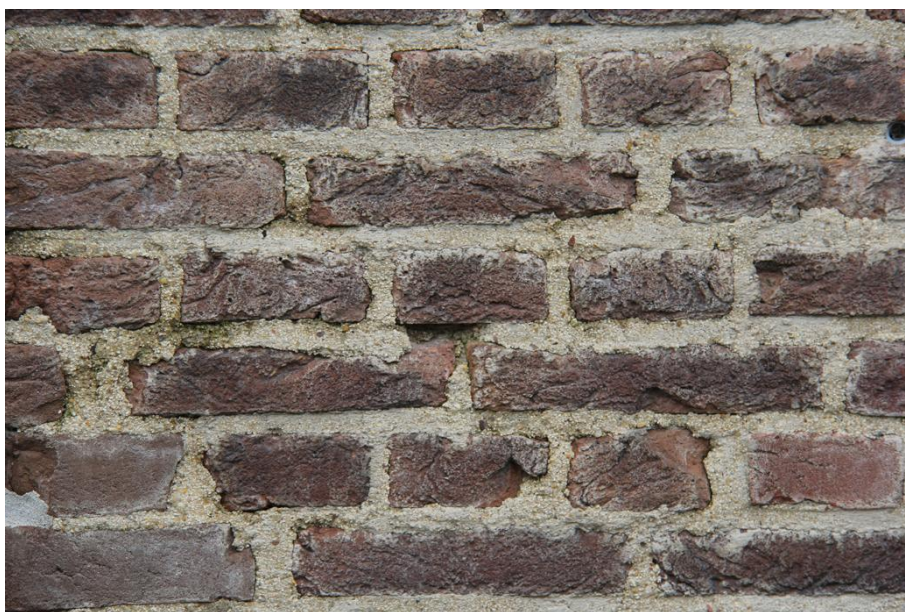
Figuur 16: 3 de voeggeneratie; uitgevallen en door zout gedegrademd.
