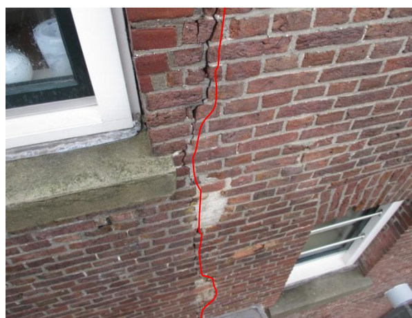
Figuur 6.94: Scheur a.g.v. corroderende elementen in het metselwerk.
