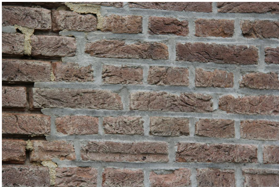
Figuur 17: 4 de generatie voegwerk nog geen voldoende leeftijd voor degradatieverschijnselen.
