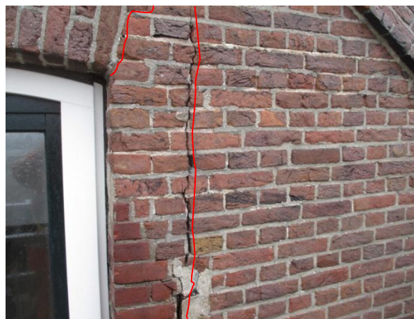
Figuur 6.92: Scheuren a.g.v. corroderende elementen in het metselwerk.
