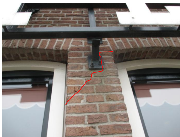
Figuur 6.46: Scheur a.g.v. corroderende elementen.
