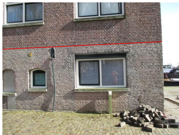
Figuur 6.28: Beschadigd metsel- en voegwerk.
