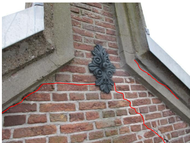
Figuur 6.47: Scheur a.g.v. corroderende elementen.
