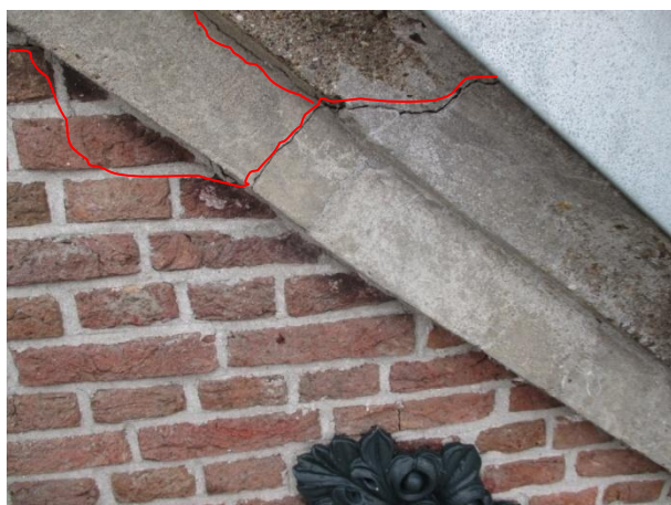
Figuur 6.49: Gescheurd element a.g.v. corroderende wapening.
