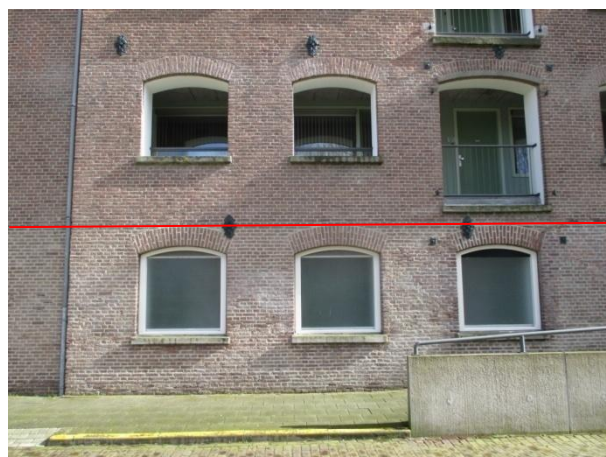
Figuur 6.24: Beschadigd metsel- en voegwerk.
