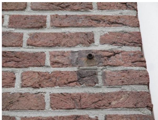
Figuur 6.60: Corroderend oud bevestigingsmiddel.
