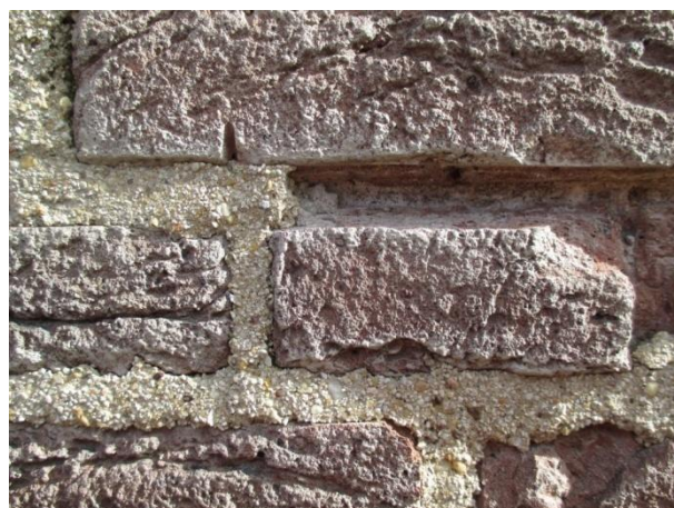
Figuur 6.30: Beschadigd metsel- en voegwerk.
