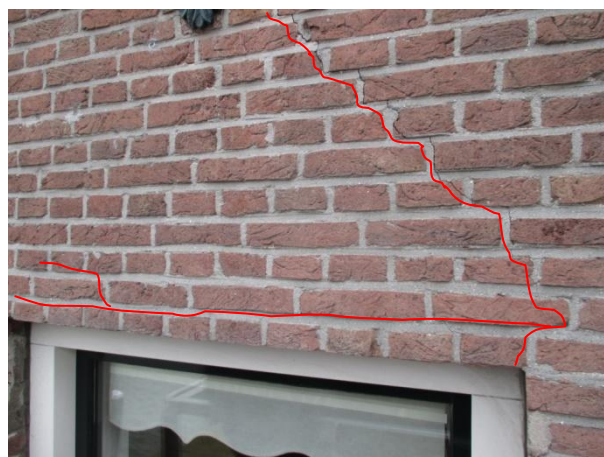
Figuur 6.74: Scheur door ontbreken van latei bij onderliggend nieuw kozijn
