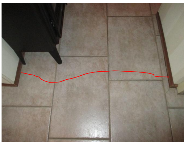
Figuur 6.128: Scheur in hard vloerafwerking op de overgang van een bouwmuur met vloerveld
