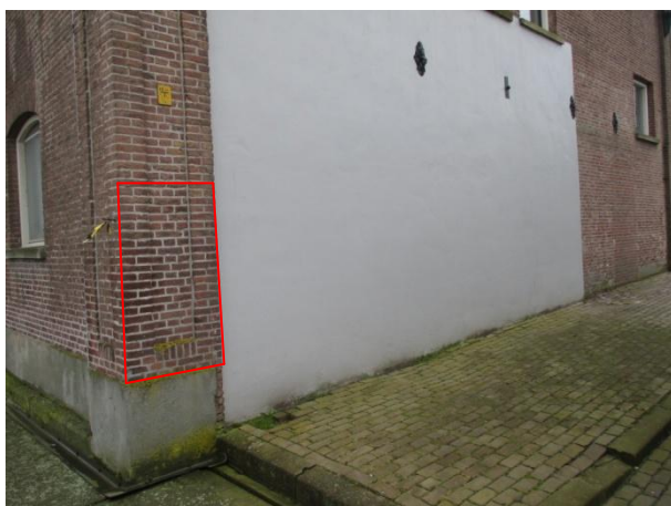
Figuur 6.79: Beschadigd voegwerk.
