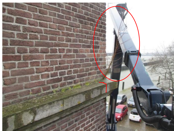
Figuur 6.16: Gescheurd element a.g.v. corroderende wapening met begroeiing.
