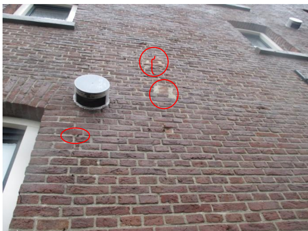
Figuur 6.113: Hersteld en opnieuw gescheurd metselwerk en een corroderend oud bevestigingsmiddel.
