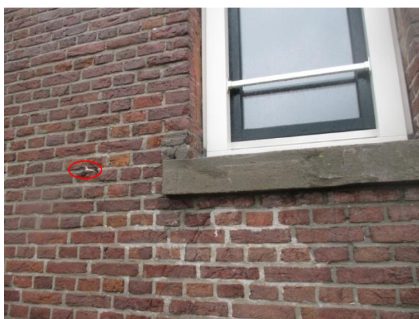
Figuur 6.109: Corroderende oude bevestigingsmiddelen.
