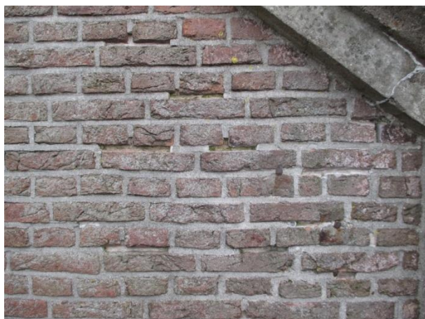
Figuur 6.53: Beschadigd voegwerk.
