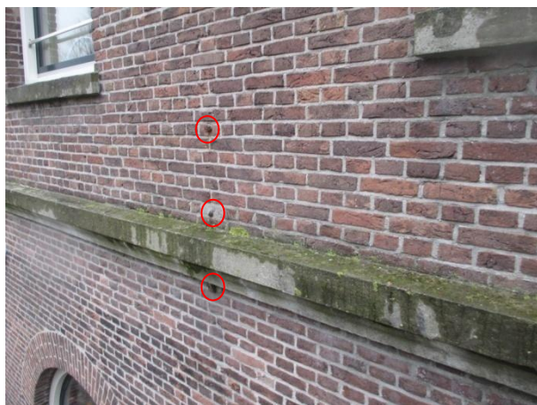
Figuur 6.19: Corroderende oude bevestigingsmiddelen.
