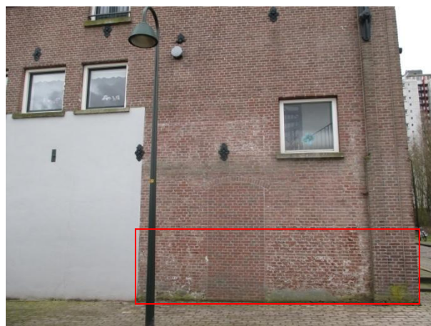
Figuur 6.80: Beschadigd voegwerk.
