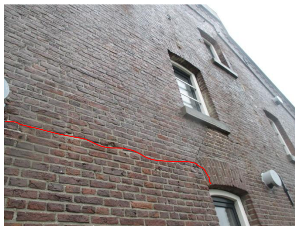
Figuur 6.106: Scheur a.g.v. corroderende elementen in het metselwerk.
