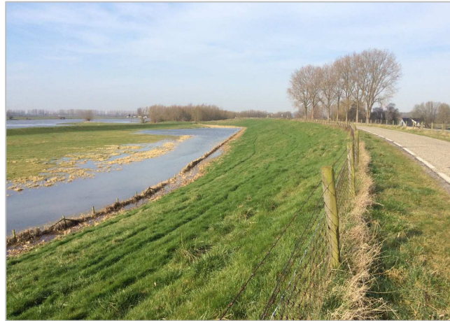
Foto: water blijft staan in de teen van de dijk.
