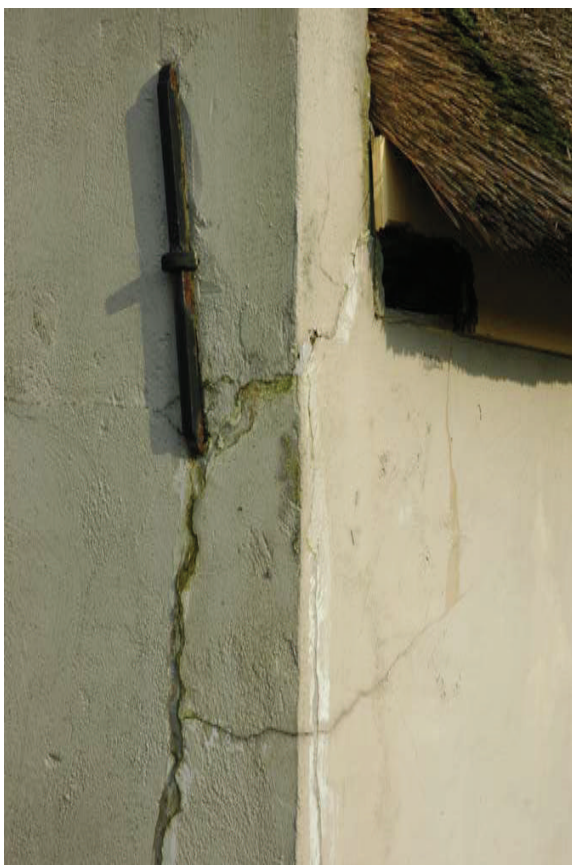
21. Hoek Noordwest- en Zuidwestgevel, scheuren in stucwerk, roestend anker
