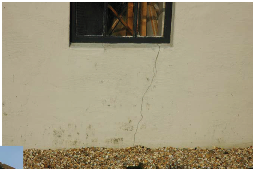
24. Zuidwestgevel - scheur in stucwerk
