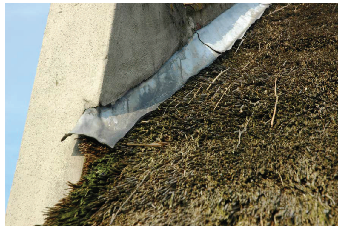
14. Zuidwestgevel, aansluiting topgevel, muurlood en riet in slechte staat
