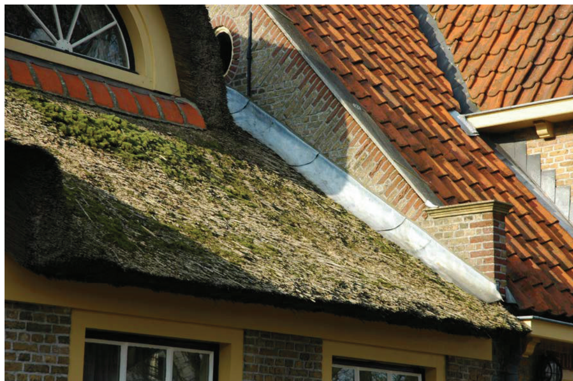
09. Zuidoostgevel, aansluiting staldak opgaande gevel, lood en riet in slechte staat
