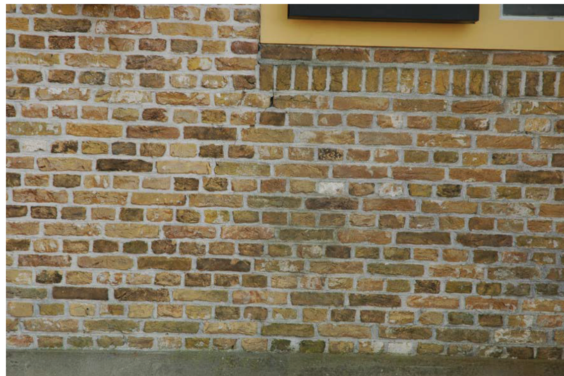
19. Noordwestgevel, uitgespoeld voegwerk schuin onder rechter kozijn
