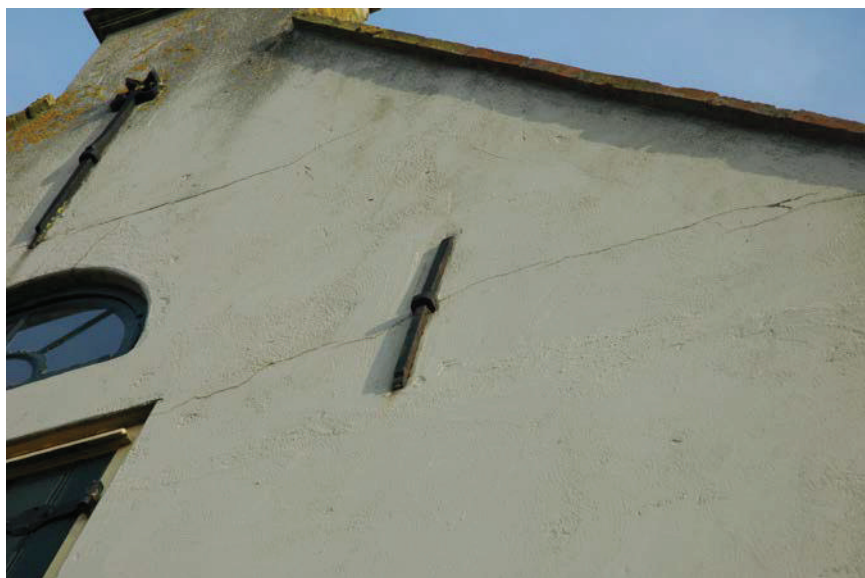
22. Noordwestgevel - scheuren in stucwerk, roestende ankers
