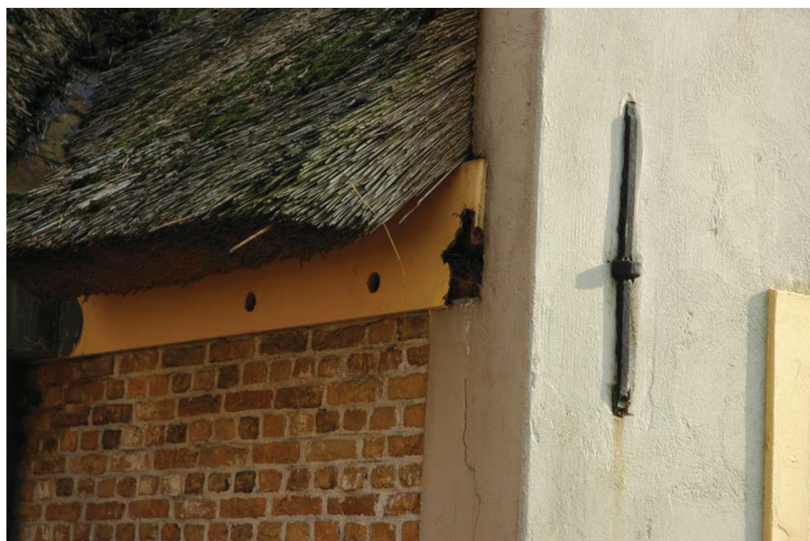
15. Noordoostgevel, muurplaat rot
