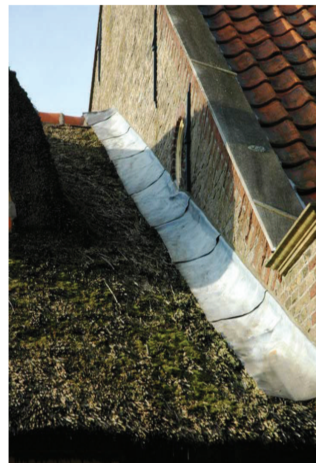
11. Zuidoostgevel, aansluiting rieten dak opgaande gevel,lood en riet in slechte staat
