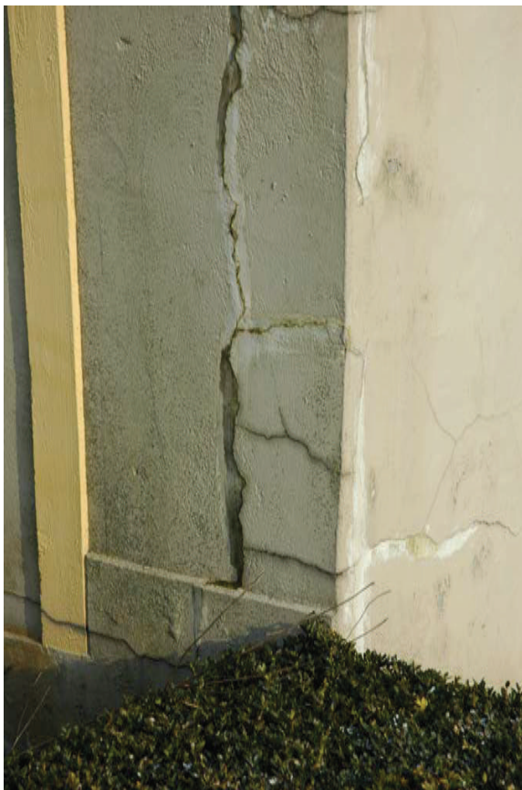
25. Hoek Noordwest- en Zuidwestgevel, scheuren in stucwerk
