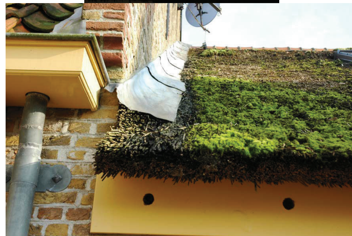
12. Noordwestgevel, aansluiting rieten dak opgaande gevel, lood en riet in slechte staat
