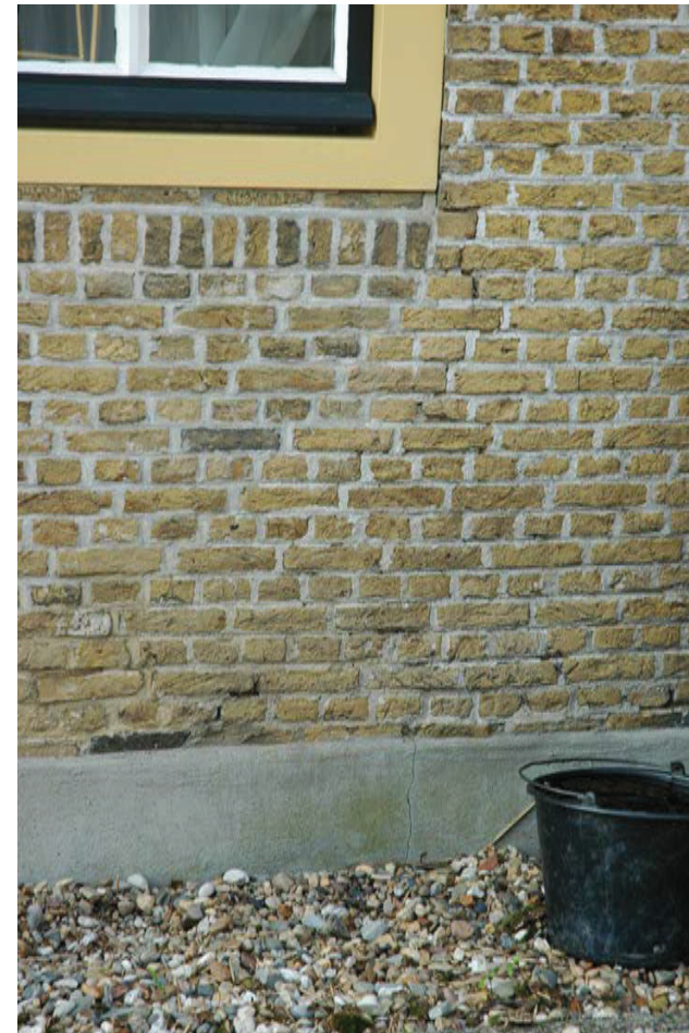
18. Zuidoostgevel - grens brandmuur, lichte scheurvorming ten gevolge van zetting
