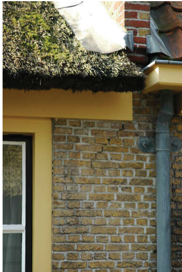
17. Zuidoostgevel - grens brandmuur, lichte scheurvorming ten gevolge van zetting
