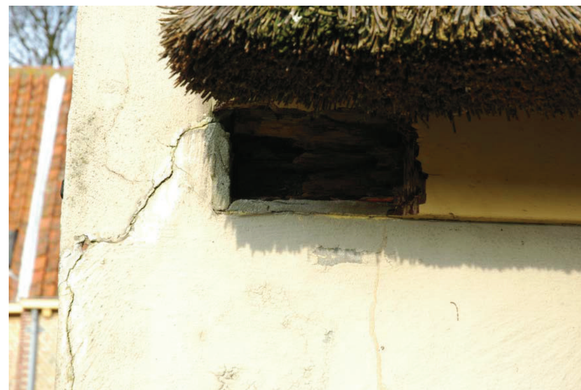
16. Zuidwestgevel, muurplaat rot
