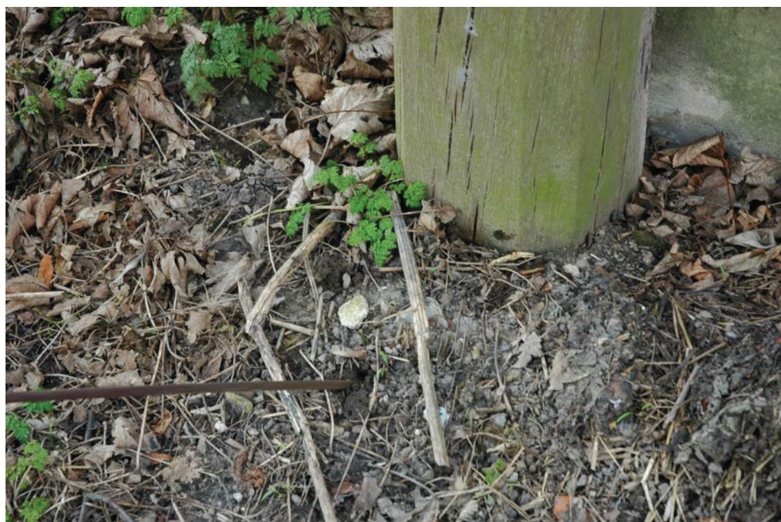
18. Staaf betonijzer steekt dwars door rotte paalvoet
