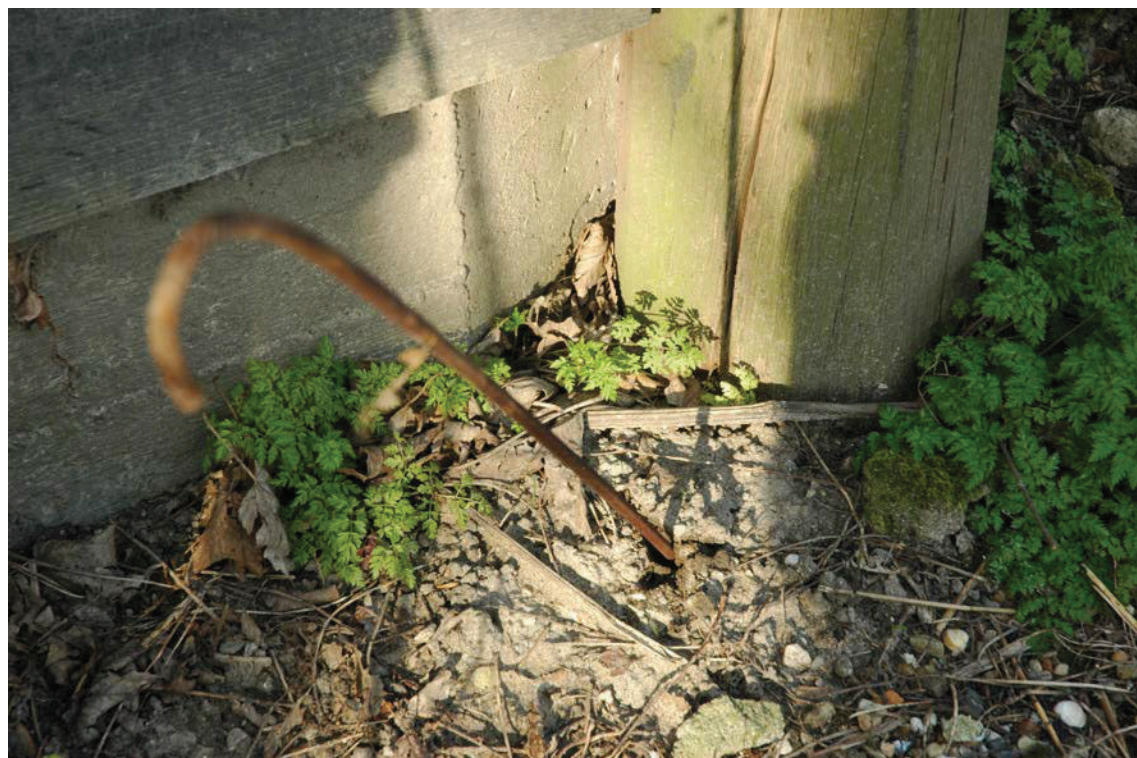
16. Staaf betonijzer steekt dwars door rotte paalvoet
