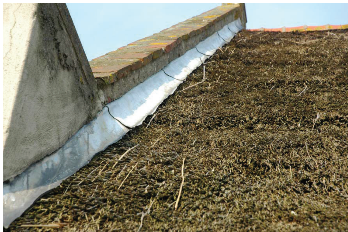
13. Zuidwestgevel, aansluiting topgevel, muurlood en riet in slechte staat
