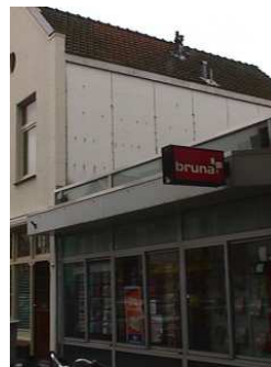
Ongewenste gevelbekleding (kunststofbeplating) op een goed zichtbare zijgevel
