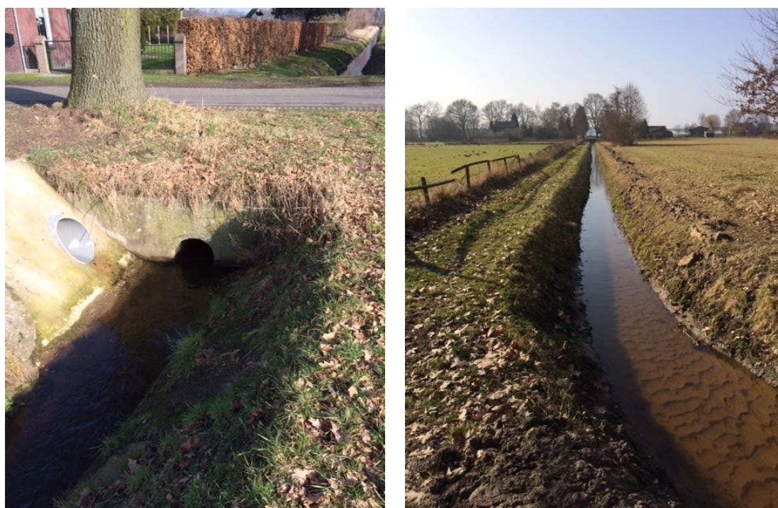
Te vervangen duiker en locatie noodstrook (februari 2017)
