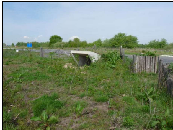
Figuur 15. Oostelijke kleinwildtunnel met nieuwe aanplant voor geleiding.
