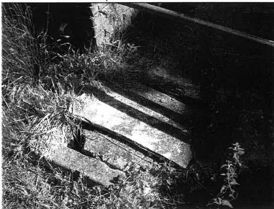
Foto 14 Asbesthoudend materiaal op maaiveld
