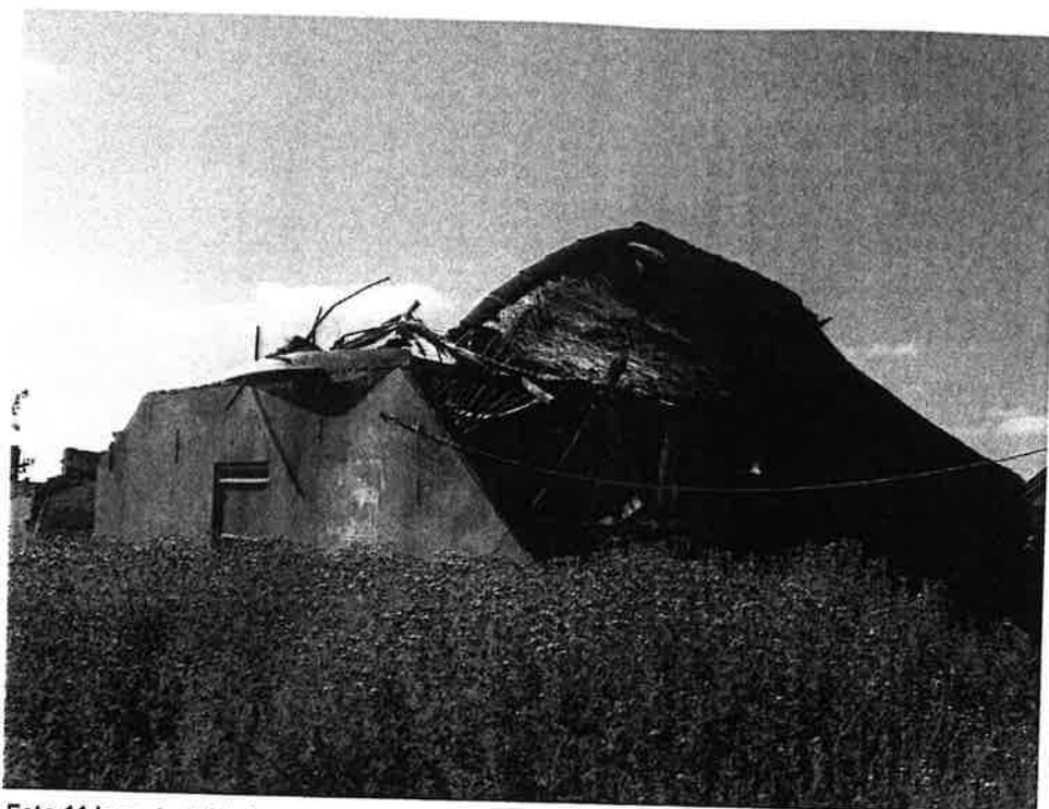
Foto 11 Ingestort dak boerderij
