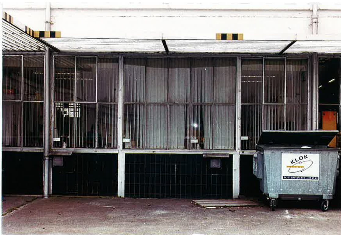
Gevel HT maart 2002 – as D travee 44-45: de oorspronkelijke dubbele draaideuren zijn vervangen door een gemetselde borstwering met een stalen glaspui erboven – de pui is niet m.b.v. de kenmerkende staalplaatjes aan de stalen stijlen en regels in de gevel bevestigd. (foto 27.03.02 - 25)
