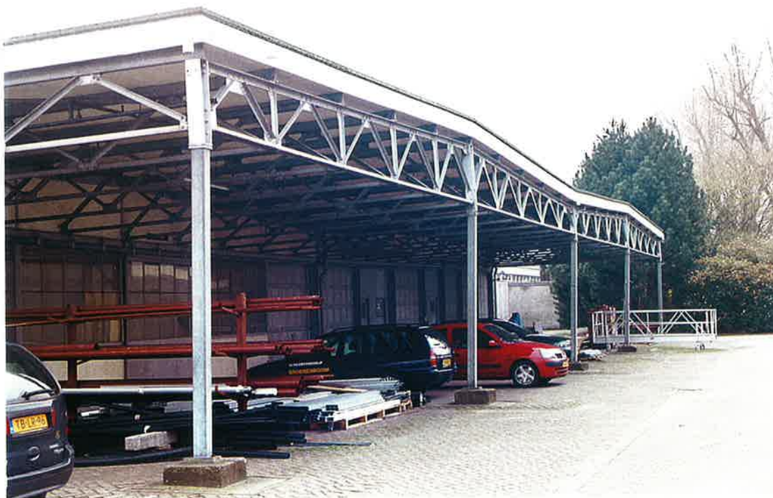
afb. 13. De kolommen onder de luifel stonden al in 1930 scheef, zo meldde de aannemer. In de Huidige Toestand zijn ze vervangen maar scheef staan ze nog altijd. (foto 27.03.02-14)
