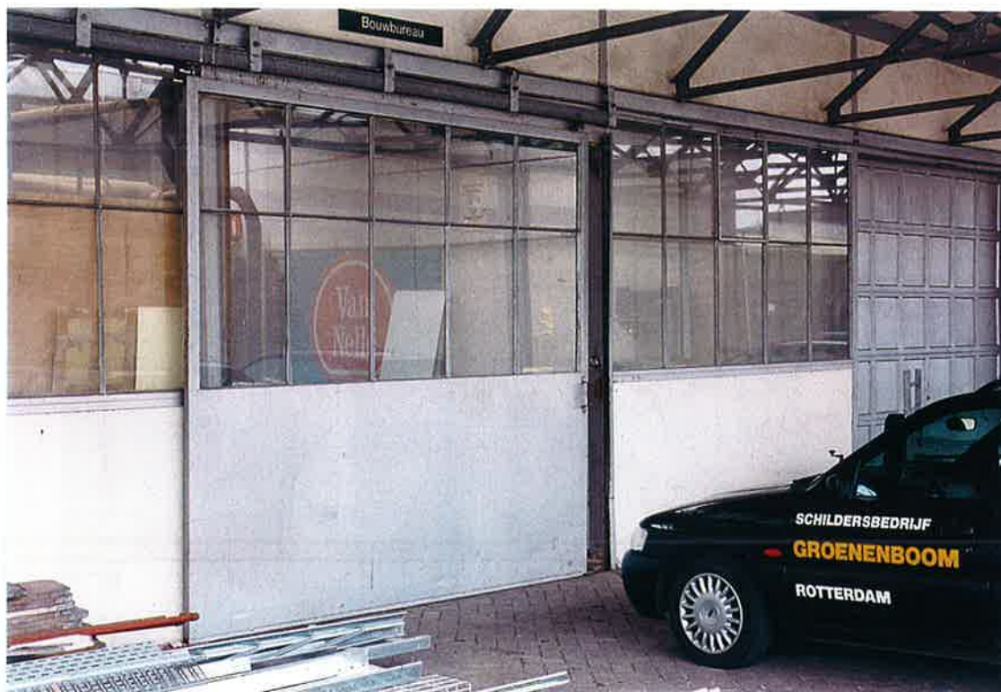
Gevel HT maart 2002 – as 50 travee D-E-F: van de zes oorspronkelijke overheaddeuren zijn er vier vervangen door gemetselde borstweringen met een stalen glaspui erboven, één overheaddeur is vervangen door een schuifpui w.b.t. indeling gelijkend op die van de gevel ernaast. (foto 27.03.02 - 13)
