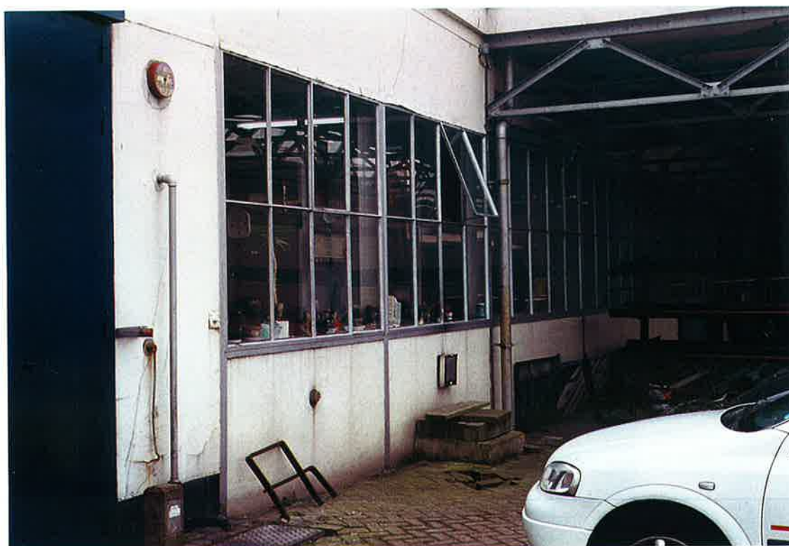
Gevel HT maart 2002 – as 50 travee C-D: de twee oorspronkelijke overheaddeuren zijn vervangen door gemetselde borstweringen met een stalen glaspui erboven – de pui is niet m.b.v. de kenmerkende staalplaatjes aan de stalen regels en stijlen in de gevel bevestigd. (foto 27.03.02 - 15)
