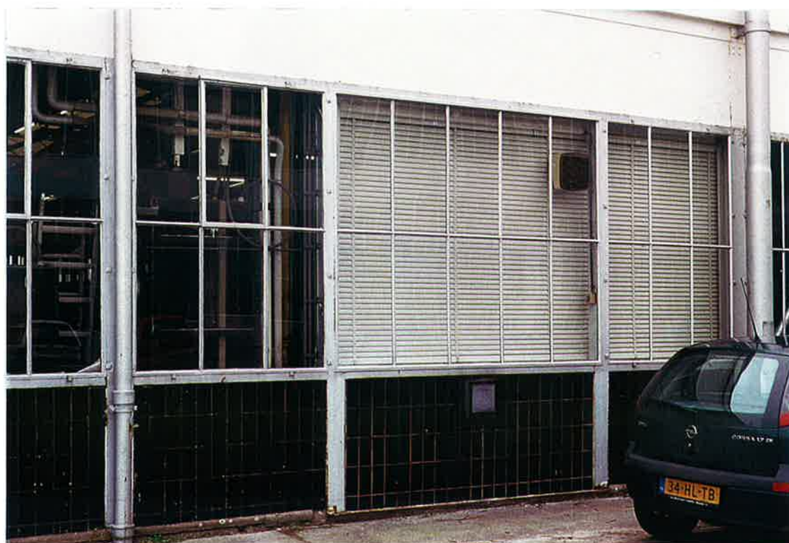
Gevel HT maart 2002 – as D travee 41-42: de oorspronkelijke draaideuren zijn vervangen door een glaspui boven een gemetselde borstwering met een gaskachel-doorvoer er in. (foto 27.03.02 - 23)
