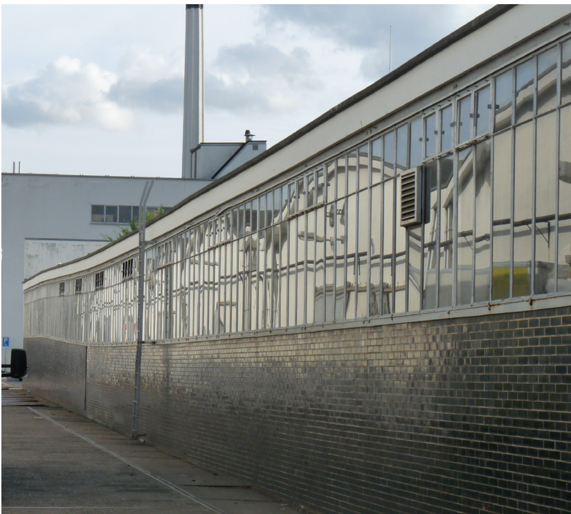
verzakte achtergevel bouwdeel A
