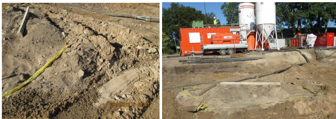
Foto's 3.12 en 3.13: situering asbest onvoorzien.
