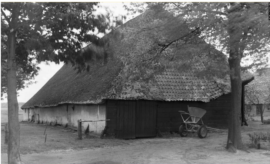
Zicht op de westelijke en noordelijke (links) gevel van de Vlaamse schuur. De noordelijke zijgevel lijkt op regelmatige afstand aan de onderzijde te zijn voorzien van stutten. Een
