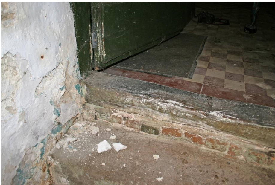
Zicht op de onderdorpel van de keldertoegang. Onder de dikke houten dorpel zijn rode bakstenen zichtbaar. Tussen de witte kalklagen zijn ook blauwe afwerklagen zichtbaar.
