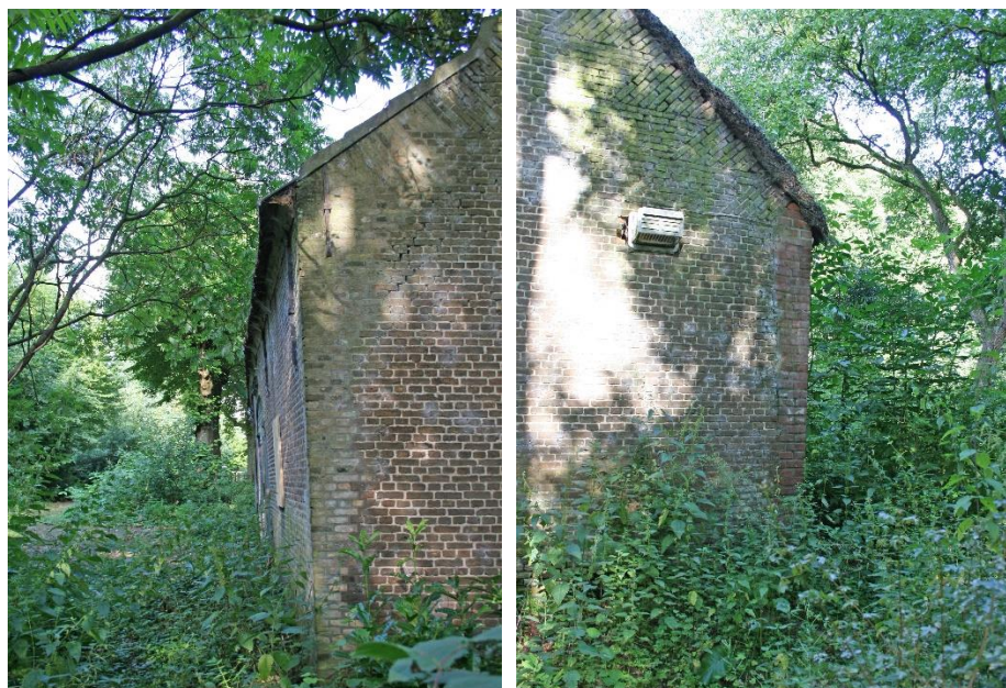
Op de linker afbeelding de aansluiting tussen de voor- en rechter zijgevel. De gehele hoek inclusief de onderste anderhalve vlechting werd vervangen (XXd). De muldenpannen zijn
