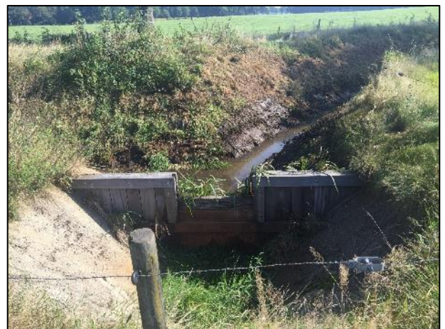
Afbeelding 2.8: schotbalkstuw in waterloop 20-0-4-3
