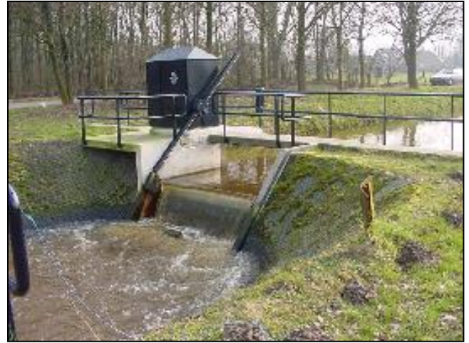
Afbeelding 2.5: automatische klepstuw in Nieuwe Oelerbeek
