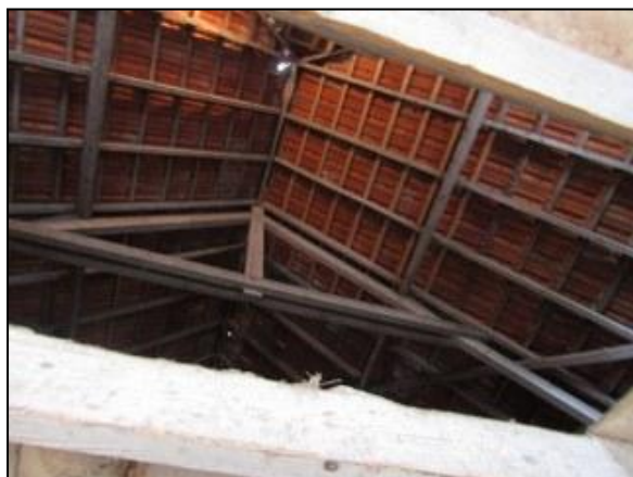
Figuur 6. In het achterhuis is geen dakbeschoot aanwezig.
