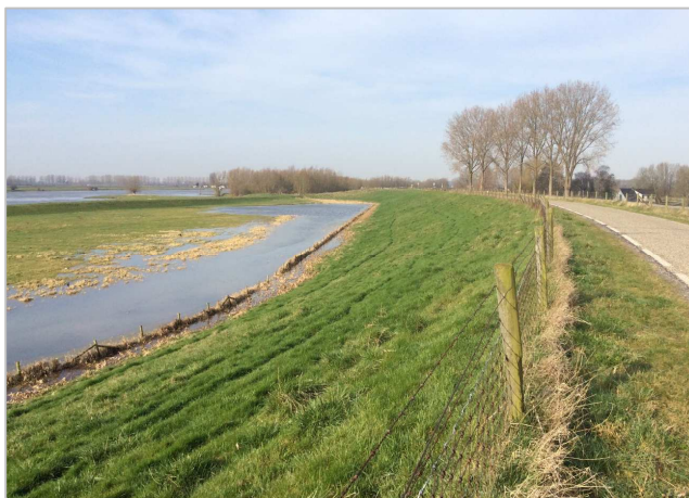
Foto: water blijft staan in de teen van de dijk.
