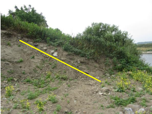
Figuur II-9 Doorsnede talud, zetsteen boven de gele lijn met daarboven de leeflaag
